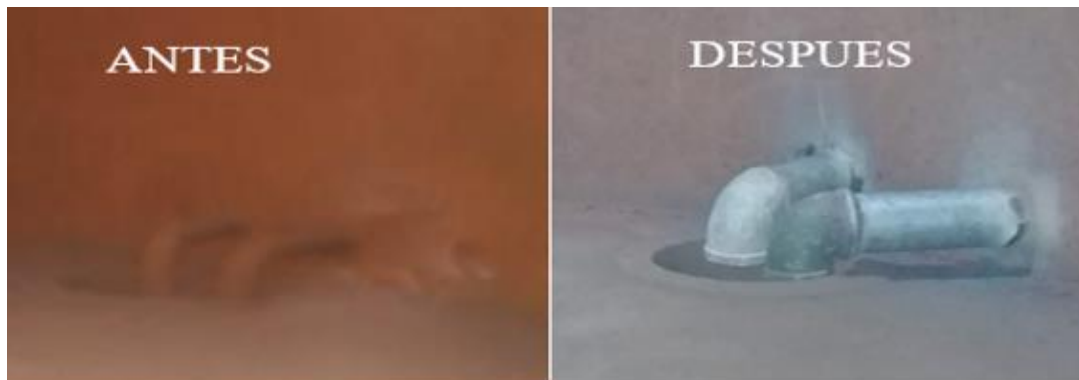
Figura 14. Mostramos el antes y el después de las tuberías de succión.
