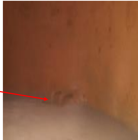
Figura 07. Vista interna de las tuberías de succión que generan el estrangulamiento.
