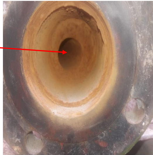
Figura 05. Brida de acoplamiento del reservorio con el sistema de bombeo.
