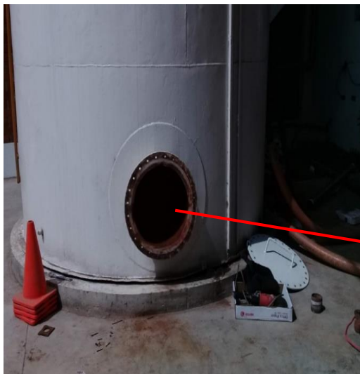
Figura 06. Manhole para ingresar a la parte interna del tanque principal.
