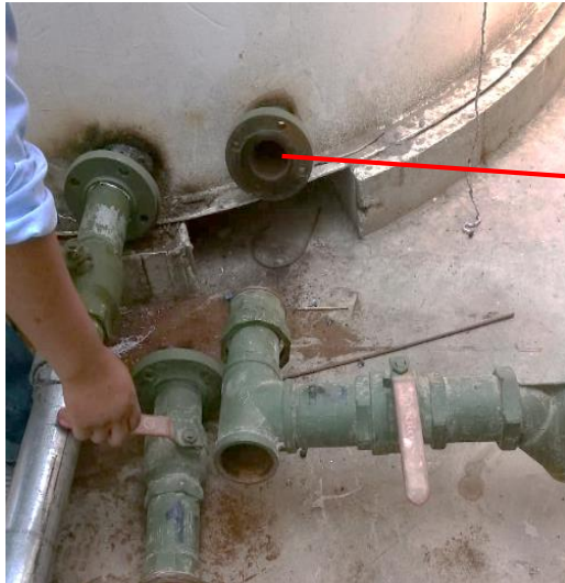
Figura 04. Vista del estrangulamiento en la parte interna de la brida.
