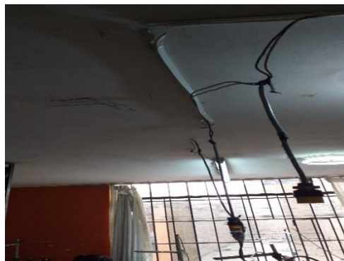
Figura 14: Falta de mantenimiento a las canaletas de luz
