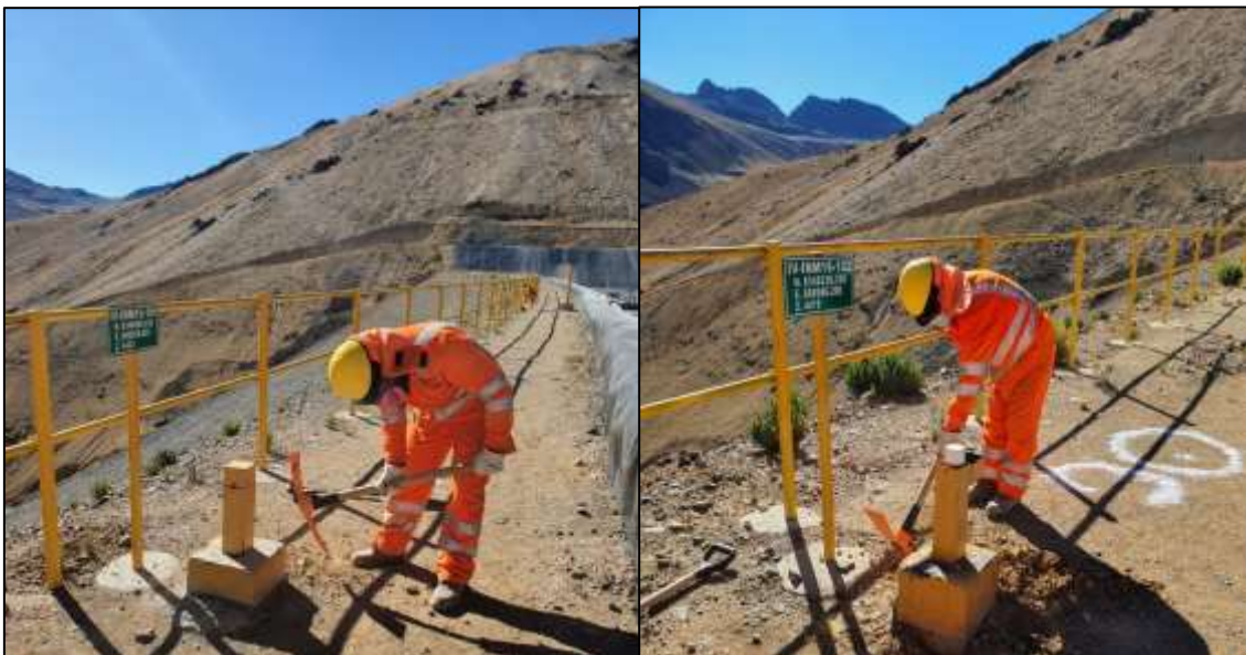
Figura N° 20: Ubicación de los pozos inclinométricos en la presa de relaves Inmaculada
