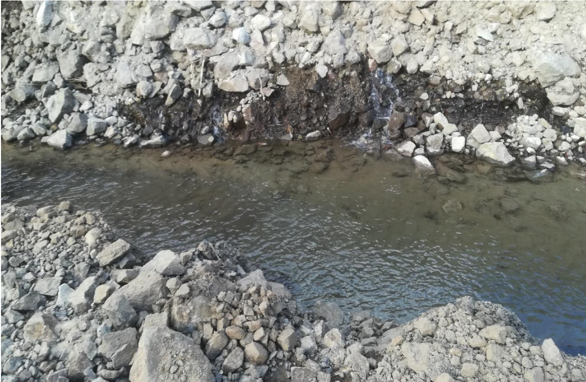
Figura 19. Filtración del estribo izquierdo de la presa proyectada en época de estiaje.
