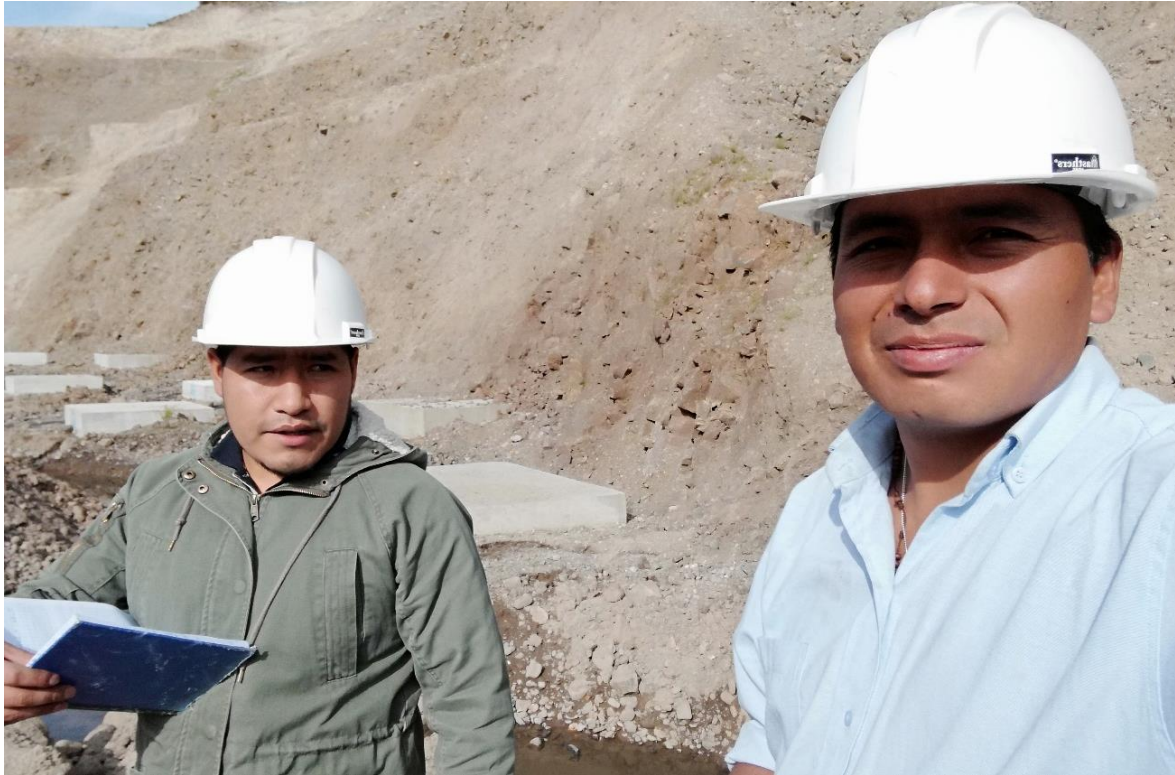
Figura 16. Verificación Geohidrológica en la zona destinada para el relleno del cuerpo de la presa y la construcción del filtro dren horizontal y vertical.
