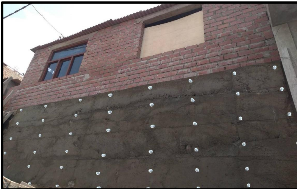
Figura N° 40: Introducción de los pernos en el muro de pirca estabilizada para la colocación de la malla
