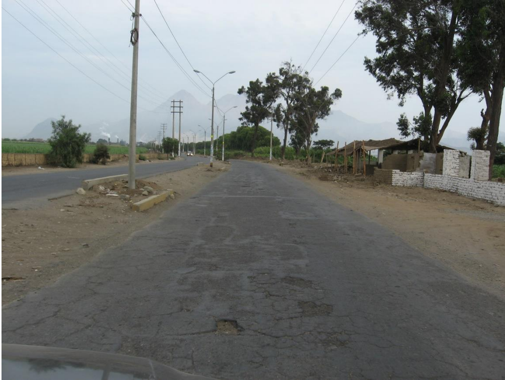
Figura 6.7: falla tipo piel de cocodrilo de la carretera Trujillo – Laredo.
