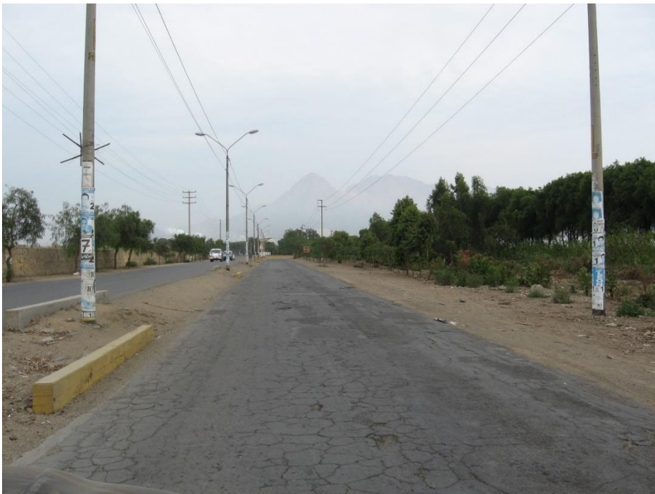
Figura 6.4: Falla tipo piel de cocodrilo carretera Trujillo – Laredo.
