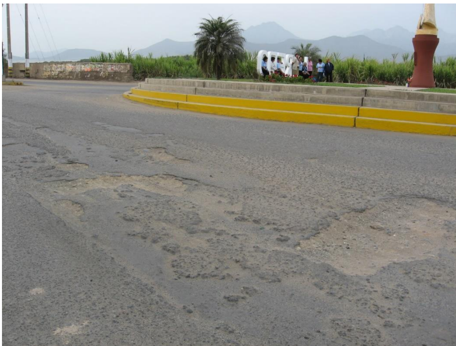
Figura 6.2: Pavimento a mejorar de la carretera Trujillo – Laredo.
