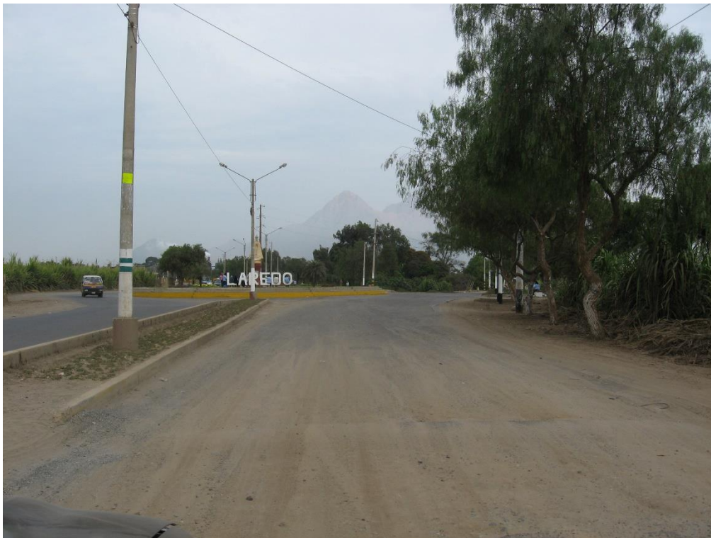
Figura 6.6: falla por ahuellamiento de la carretera Trujillo – Laredo.
