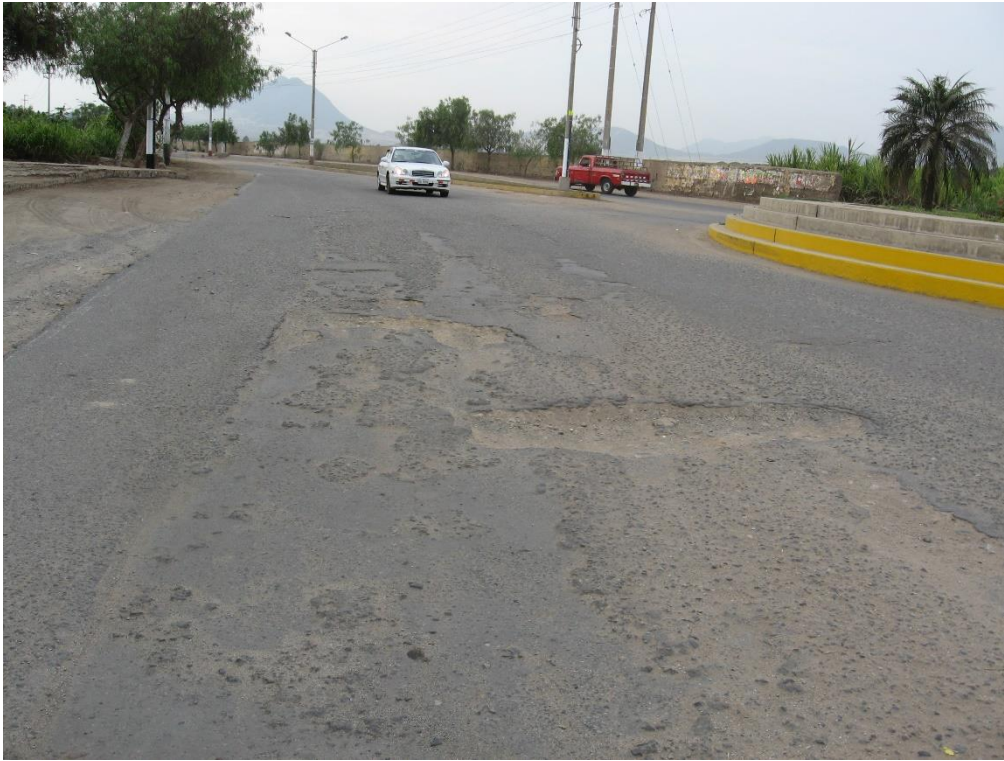
Figura 6.5: falla por ahuellamiento de la carretera Trujillo – Laredo.
