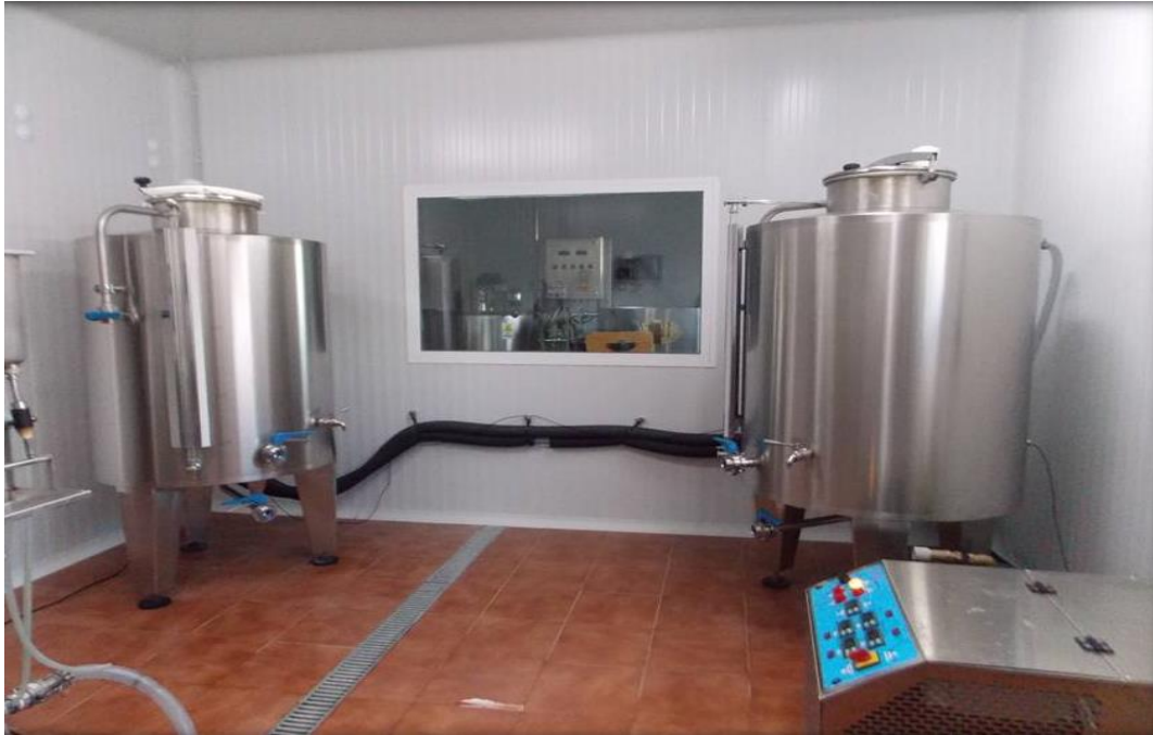
Fotografía 7. Tanques de fermentación.
