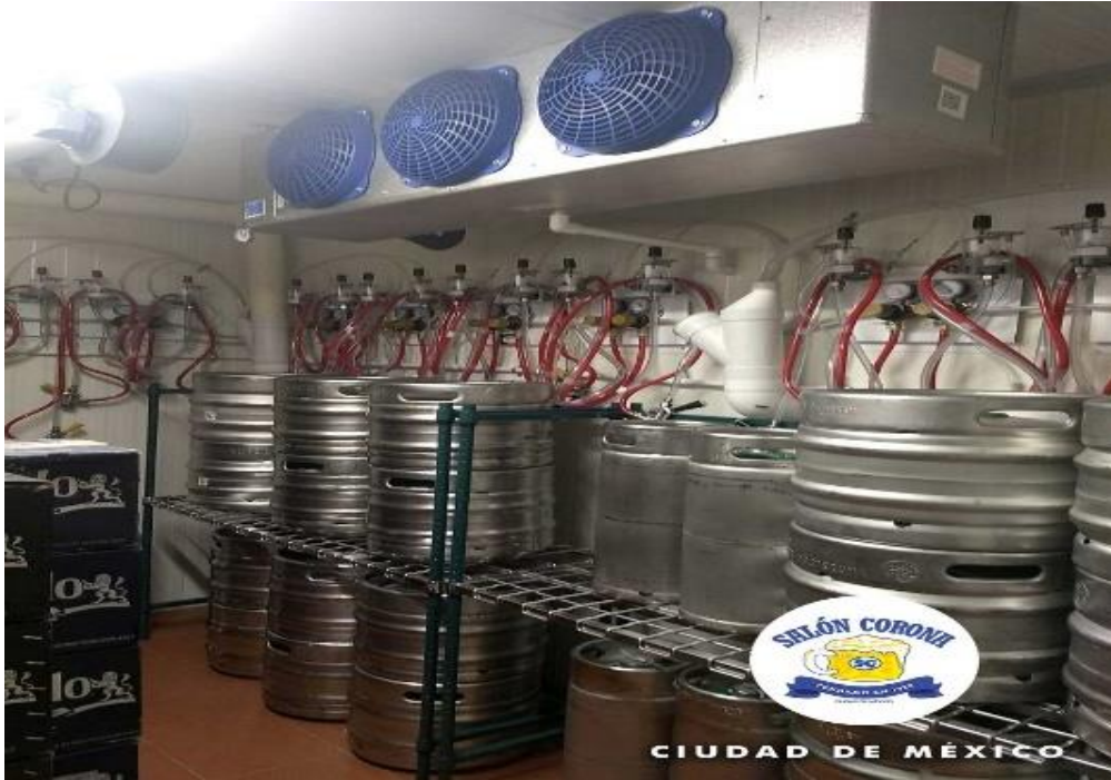
Fotografía 5. Ventilación en almacén.
