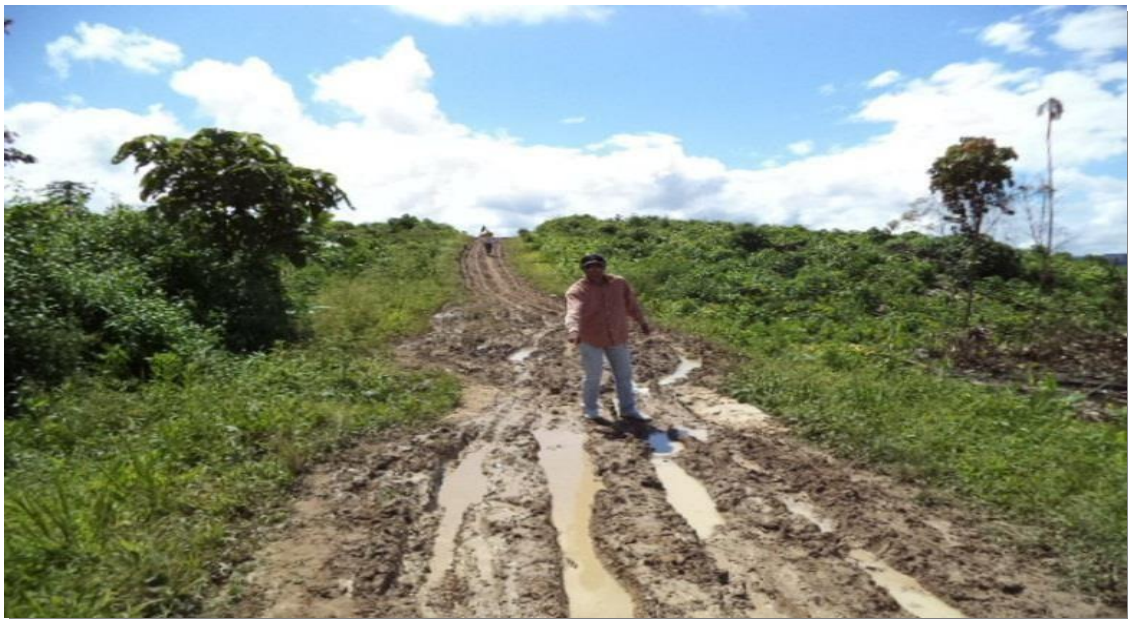
Panorama del estado crítico de la vía. donde se hace imposible el tránsito vehicular. km 07+560 – km 07+843
