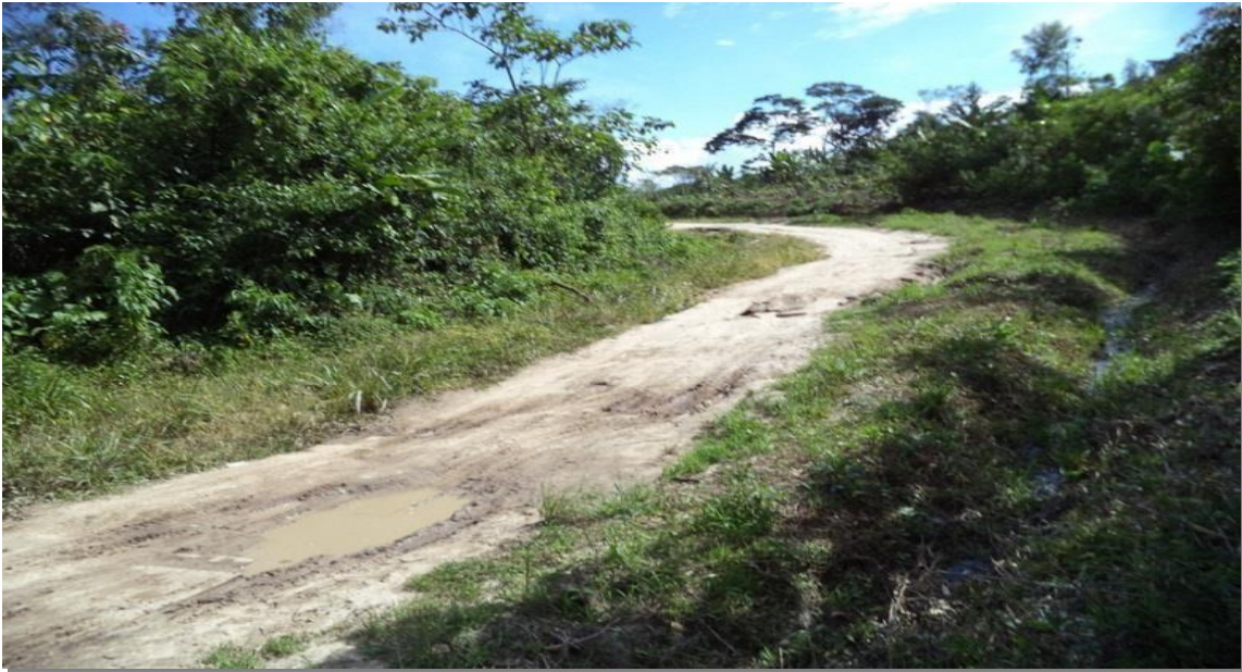
Se observan la carpeta con ahuellamiento y baches cubiertos de agua, así como las cunetas de tierra cubiertas de vegetación. km 06+233
