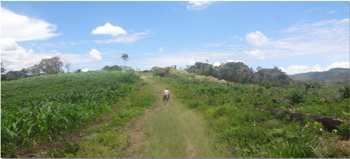
Se observa la carpeta de rodadura completamente cubierta de vegetación, lo que hace difícil el tránsito vehicular. km 10+026.
