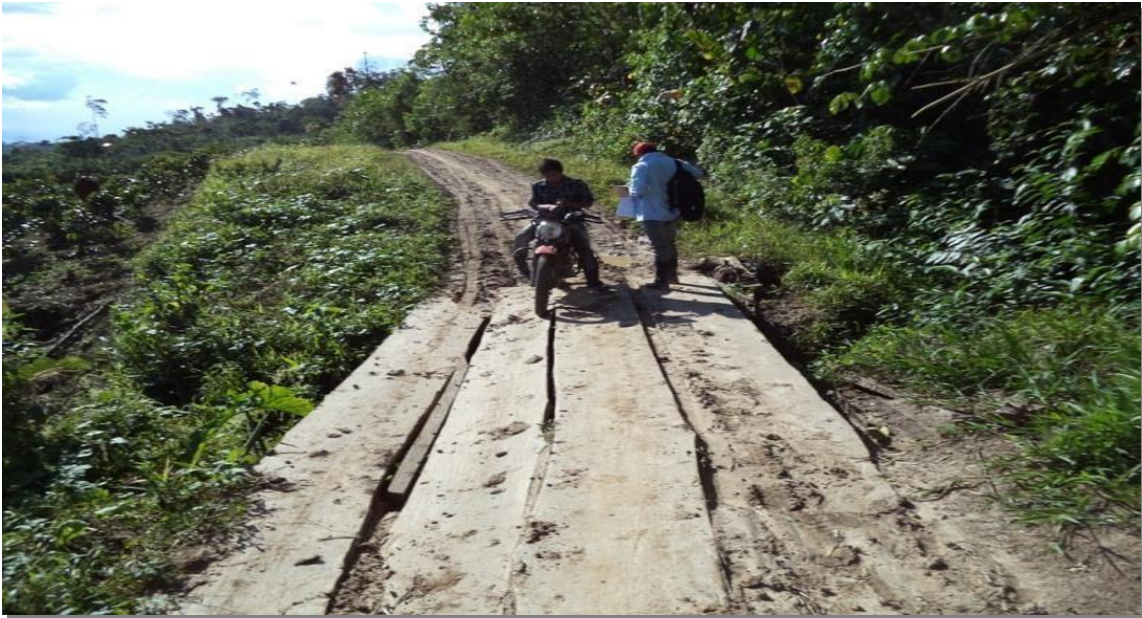
Panorama del estado de conservación en el que se encuentra el cruce de madera existente, tramo km. 9+400. se reemplazará por una alcantarilla de 60" (2 ojos).
