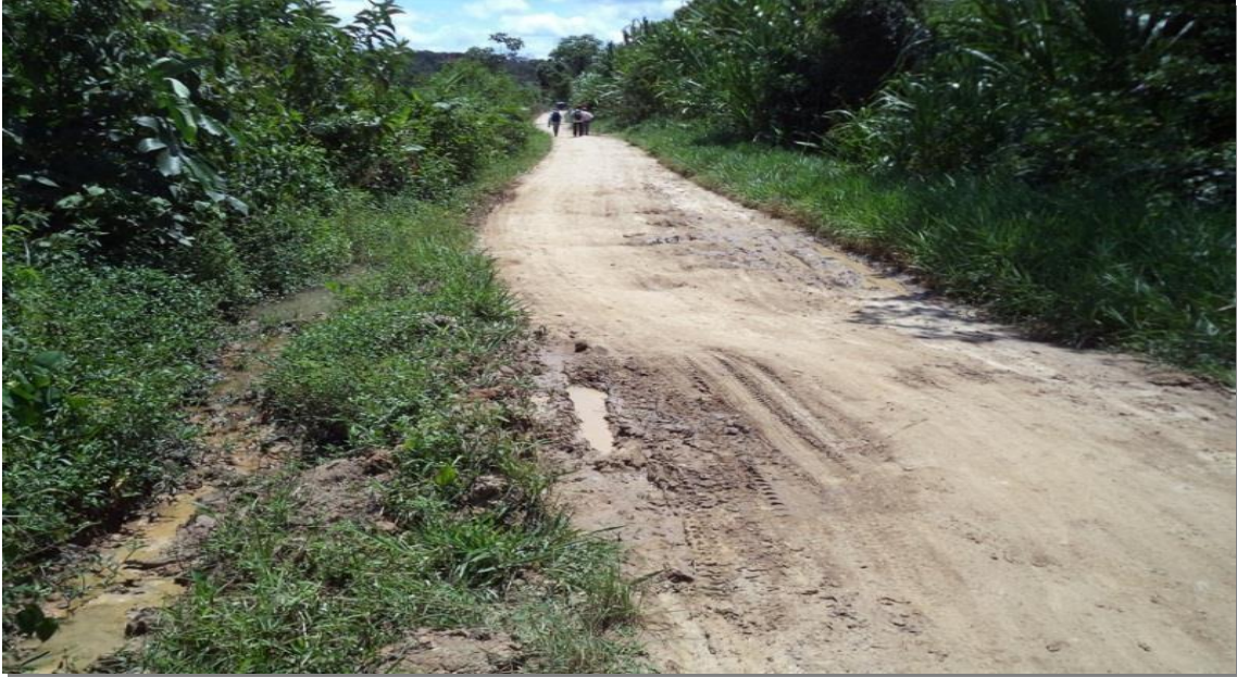
Se observa la vía totalmente invadida de agua debido a las constantes precipitaciones en la zona, además de la falta de bombeo. km 1+340
