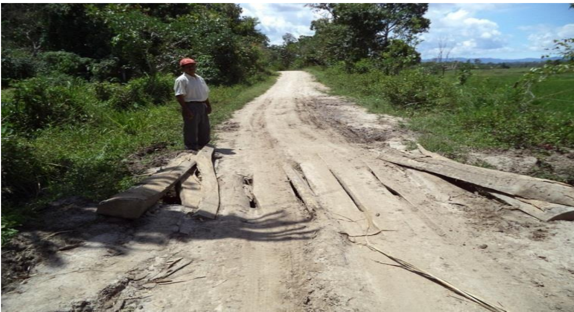
Panorama del estado de conservación en el que se encuentra los tablones de madera existente, tramo km. 2+380. se reemplazará por una alcantarilla tmc d=48" de Long. = 7.50m
