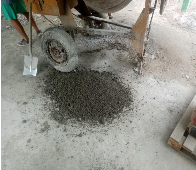
Foto 9: SE OBSERVA LA ELABORACION DEL CONCRETO PARA LA MUESTRA PATRON DE LOS BLOQUES DE CONCRETO
