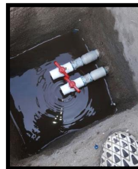
Figura 18 Efluente tratado de biofiltro implementado
