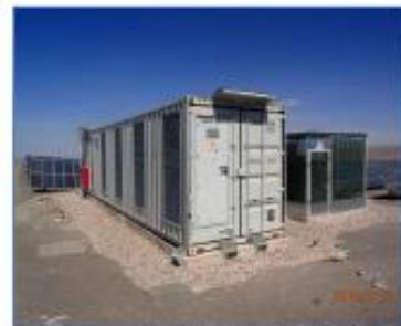
Caseta de inversores y transformadores
