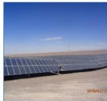
Vista de los paneles solares
