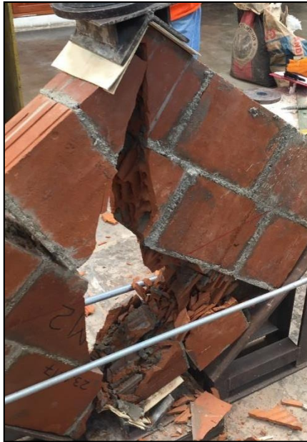
Foto 14: Falla mixta en tabique M-1
