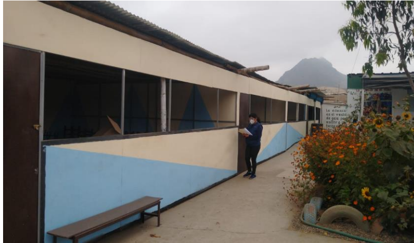
Inexistencia de ventanas en aulas del nivel primario Fuente: Elaboración propia
