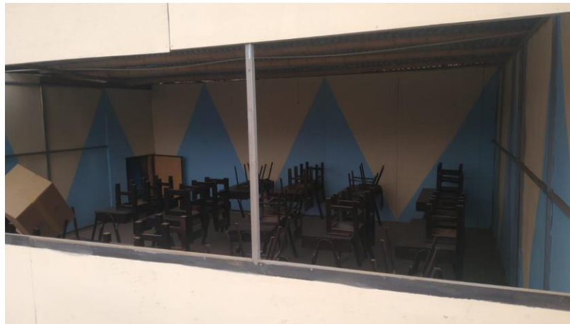
Organización de mobiliario en trama (en deterioro) Fuente: Elaboración propia
