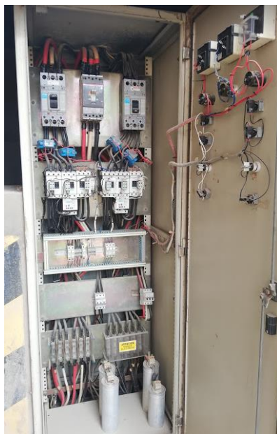
Figura 9: Tablero de distribución trifásico interno
