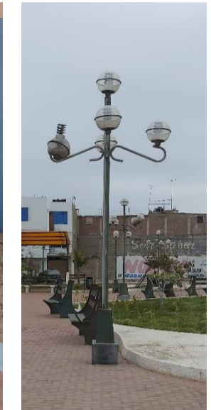
C Poste de alumbrado
