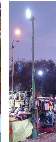
C Poste de alumbrado
