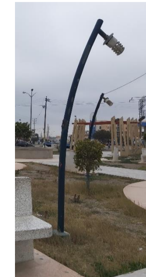
C Poste de alumbrado
