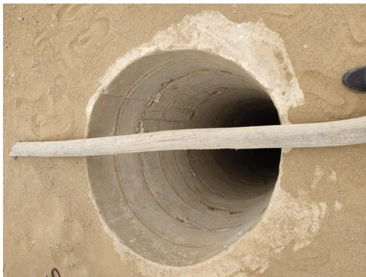
Figura 41. Pozo Tubular existente en el AA. HH. El Sol Del Tablazo - Huanchaco
