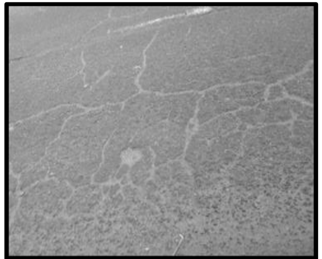
Figura N°51: Agrietamiento en bloque
