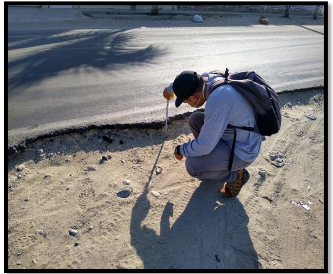
Figura N°45: Desnivel de carril
