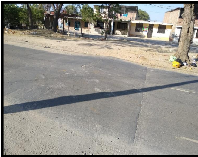
Figura N°50: grietas longitudinales y transversales
