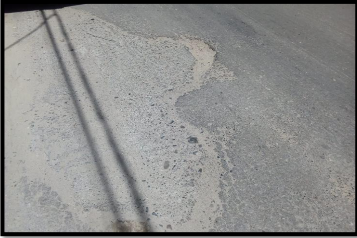
Figura N° 40: Desprendimiento de agregados
