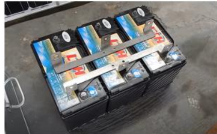
Baterías solares Cilado profundo 330 Ah
