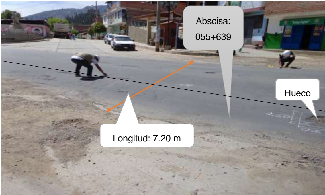
Gráfico 1. Inspección del pavimento tramo Cruce Taricá- Jangas
