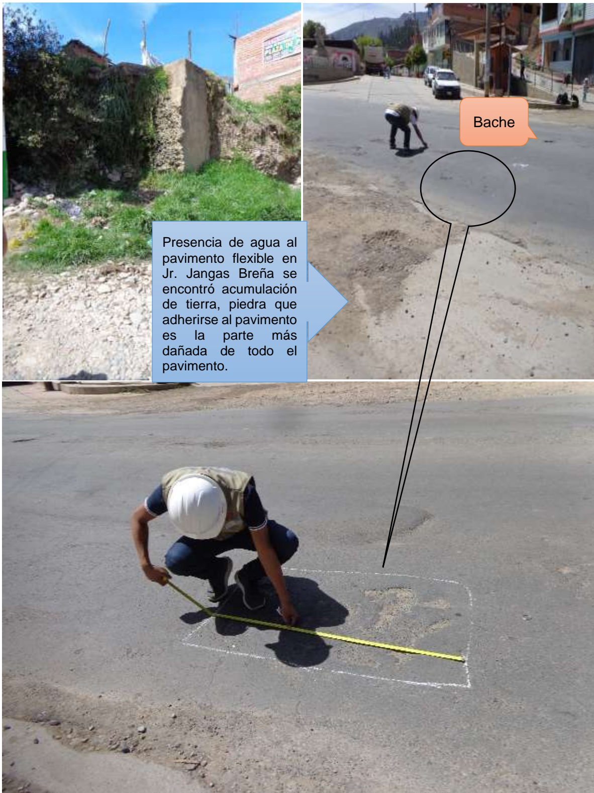
Gráfico 3: Evidencia de las causas del deterioro tramo Cruce Tarica- Jangas
