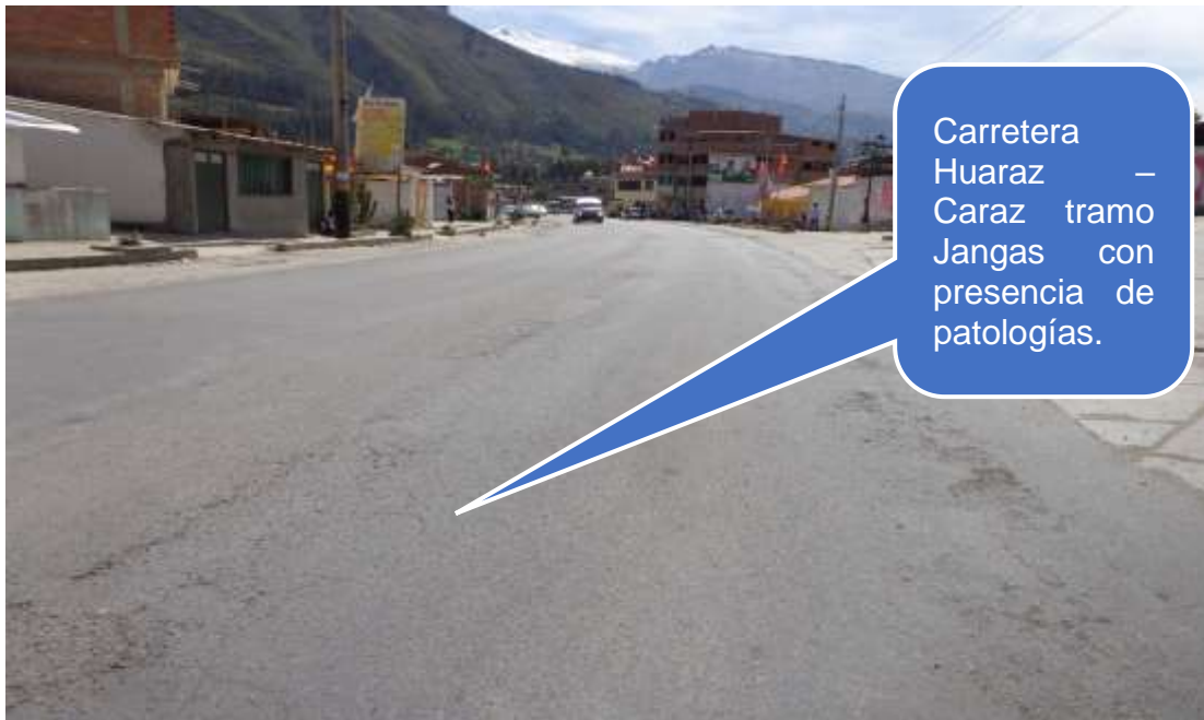
Gráfico 4. Evidencia del estado del pavimento en la carretera de Huaraz – Caraz
