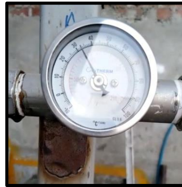
Control de temperatura
