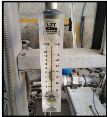
Control de caudal
