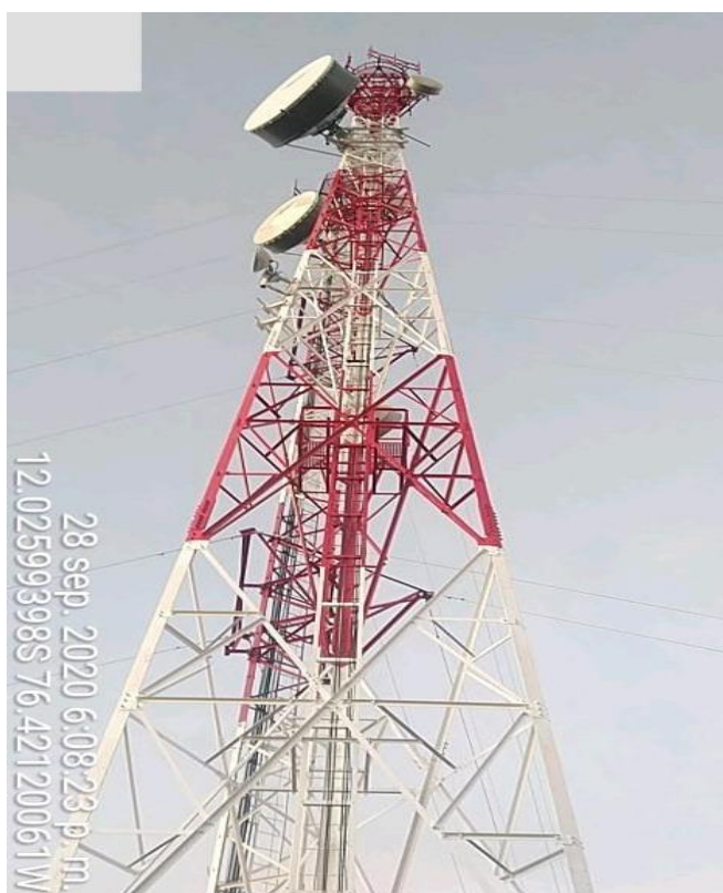
Figura 1. Torre autoportada triangular 49 m
