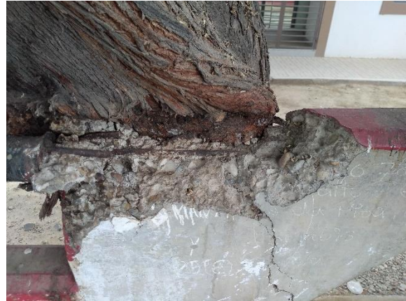
Imagen 18: El tronco de algunos árboles generan agrietamiento y fisuras a la infraestructura
