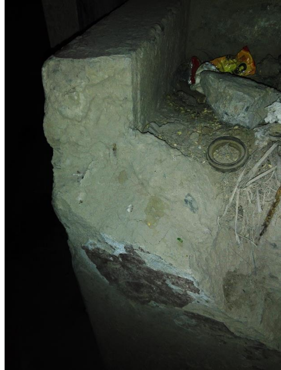
Imagen 06: Mal estado de conservación en la infraestructura del malecón
