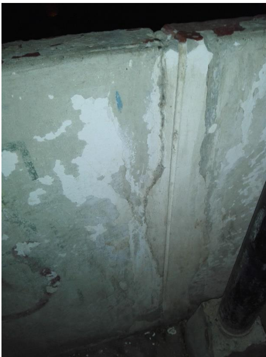
Imagen 07: Mal estado de conservación en la infraestructura del malecón
