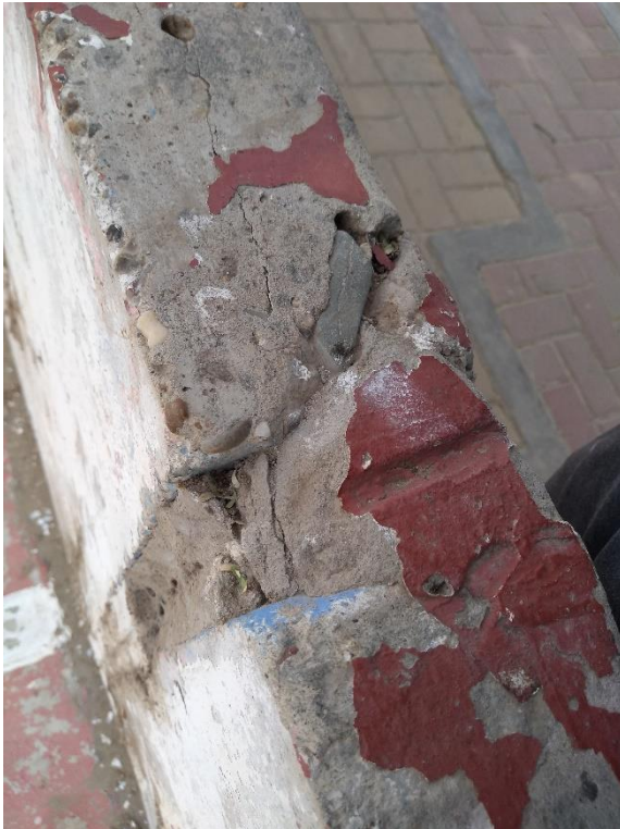
Imagen 29: Fisuras en la infraestructura de los muros de contención.
