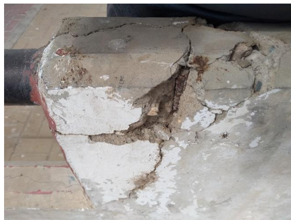
Imagen 21: Fisuras en la infraestructura de los muros de contención.
