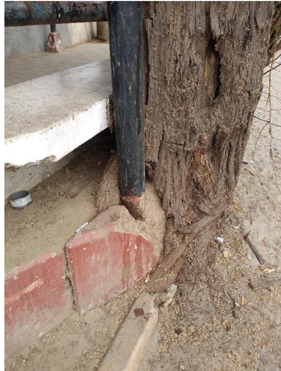
Imagen 30: El tronco de algunos árboles generan agrietamiento y fisuras a la infraestructura
