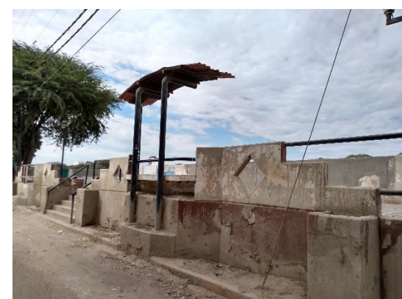
Imagen 22: Falta de mantenimiento constante en las fachadas.
