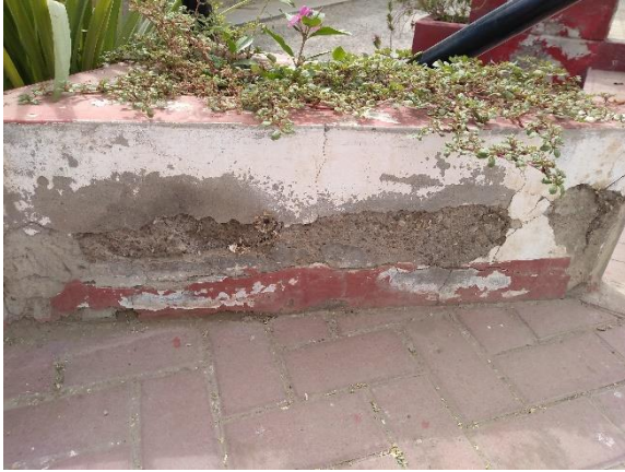
Imagen 27: Descascaramientos producto de la humedad que sufrió el malecón.
