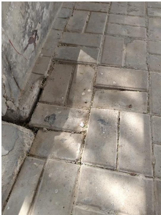
Imagen 16: Deformaciones visibles sobre el suelo o piso del malecón Eguiguren.
