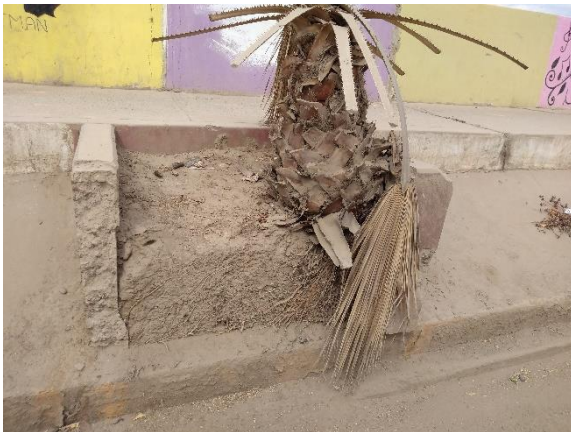
Imagen 19: Las jardineas han colapsado, dejando de incumplir sus funciones.
