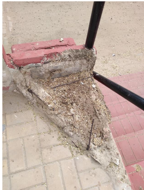
Imagen 08: Mal estado de conservación en la infraestructura del malecón
