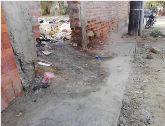
Imagen 01: Mal estado de conservación en la infraestructura del malecón
