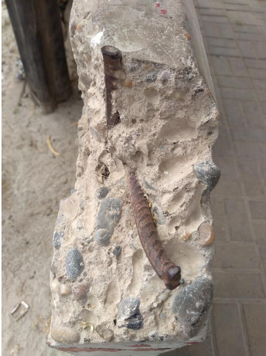
Imagen 05: Mal estado de conservación en la infraestructura del malecón
