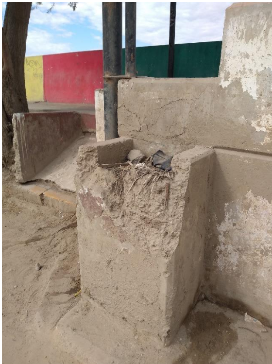
Imagen 25: Las jardineas han colapsado, dejando de incumplir sus funciones.
