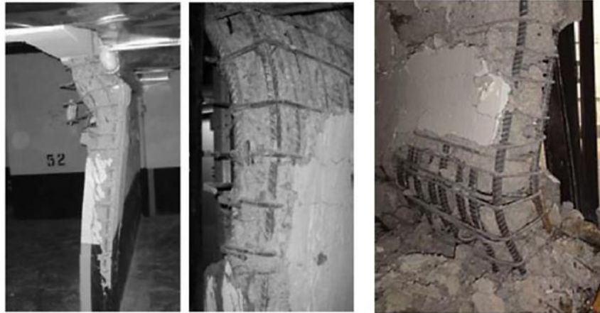
Figura 1. Pandeo de muros fuera de plano
