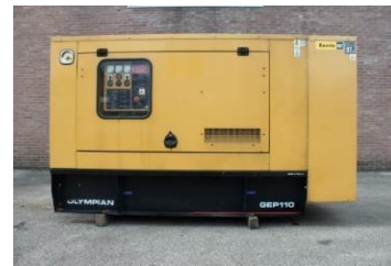
GENERADOR OLYMPIAN GEP 110
