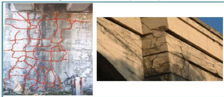
Figura 02. Deterioro por ataque de sulfato
