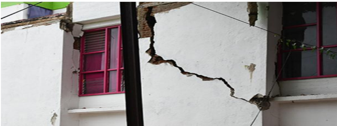
Figura 7. Grieta diagonal Tras un Sismo
