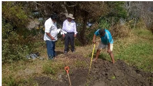
Fotos se aprecia realización de calicatas en el canal de riego Yalcuchique
