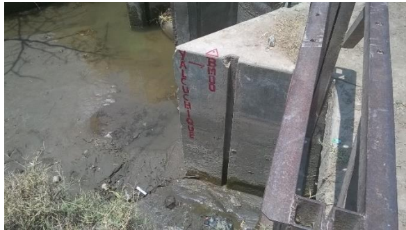
Fotos en la que se aprecia el BM del canal de riego Yalcuchique sobre el muro.
