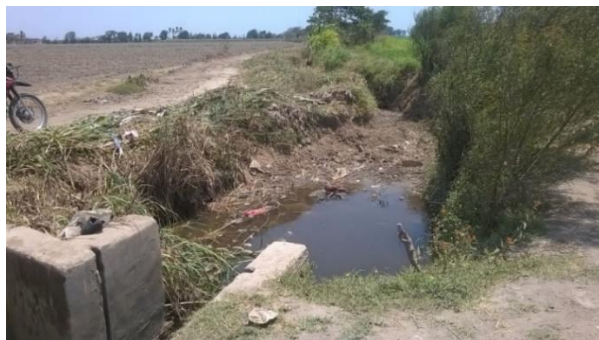
Fotos se aprecia tramos erosionados del canal de riego Yalcuchique
