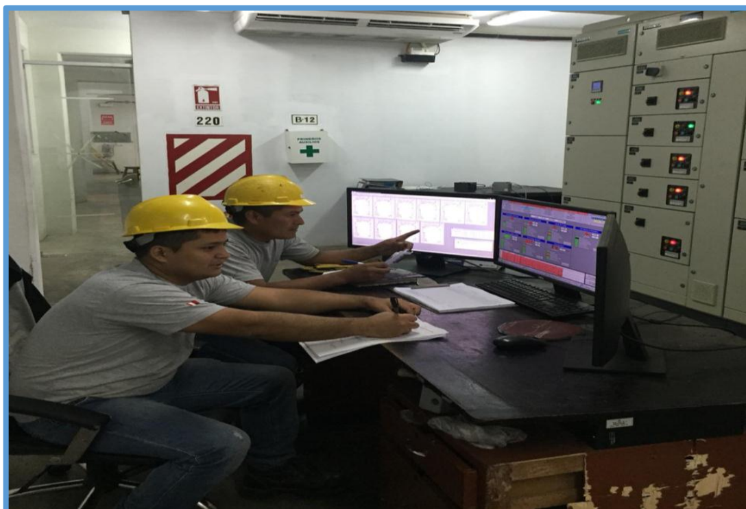
Anexo 20: Toma de datos, sala de control de planta de fuerza Cartavio S.A.A.
