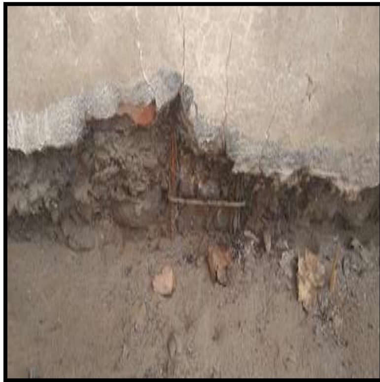
Figura 1: Presencia de humedad en la estructura de concreto armado.
