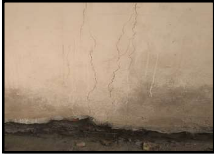
Figura 2: Presencia de fisuras en la estructura del concreto armado. Fuente: Preparación propia.
