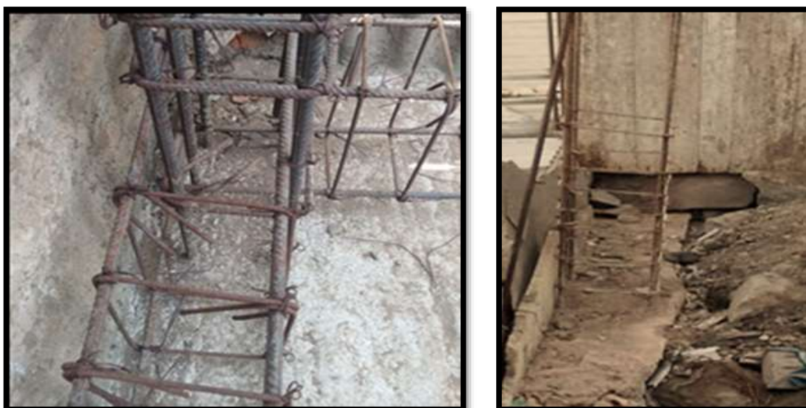
Figura 4: Presencia de oxidacion en la estrucra del concreto armado.
