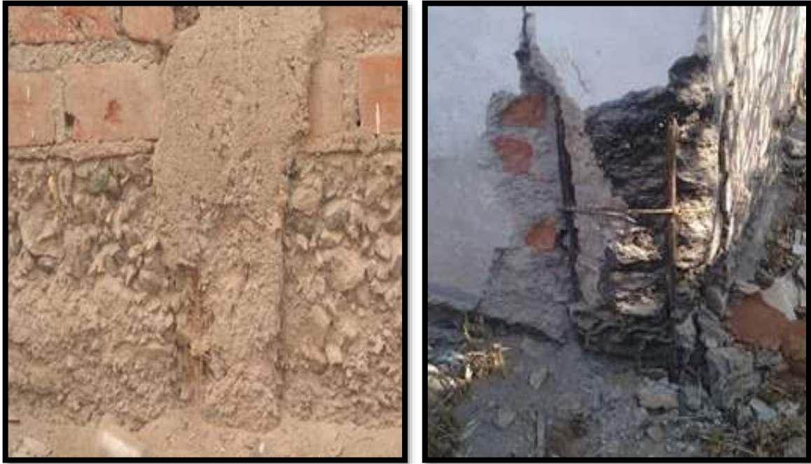
Figura 5: Presencia de corrosión en la estructura de concreto armado.
