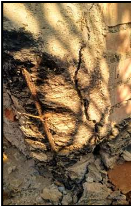
Figura 3: Presencia de grietas en la estructura del concreto armado.
