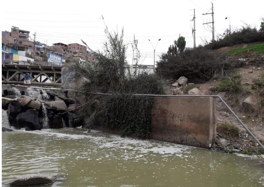
Imagen 4. Recorrido de la tubería de alimentación hasta la bomba de ariete hidráulico, 18 m de longitud y una altura total de 2.30 m.
