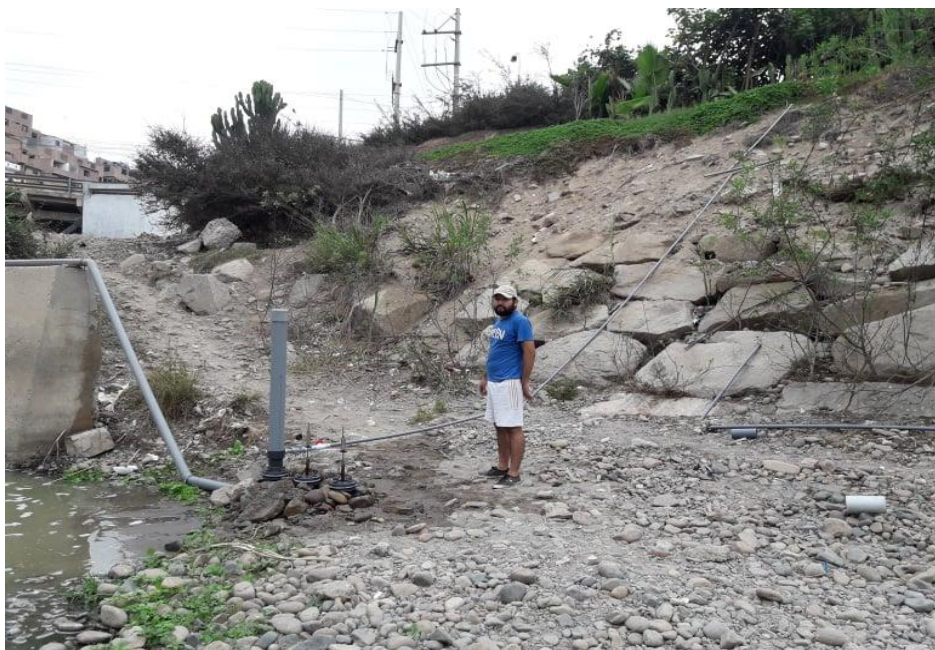
Figura 22: Sistema completo de la bomba de ariete hidráulico antes de puesta en prueba.
