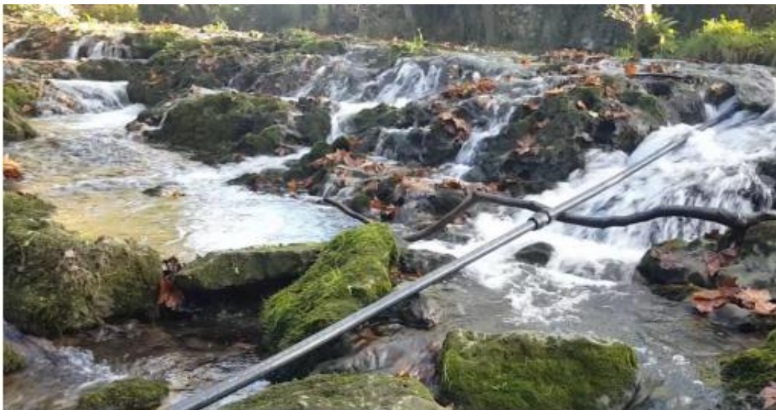
Figura 11: Tubería de alimentación de polietileno de alta densidad (HDPE)
