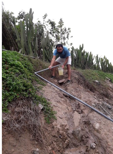
Imagen 8. Ensayo de campo, prueba de caudal de llegada a una altura de 8 m.
