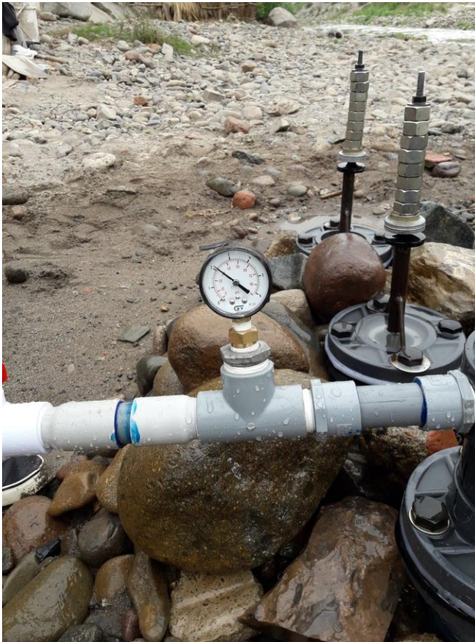
Figura 29: fotografía de la presión ejercida por la bomba de ariete. Fuente: Elaboración propia
