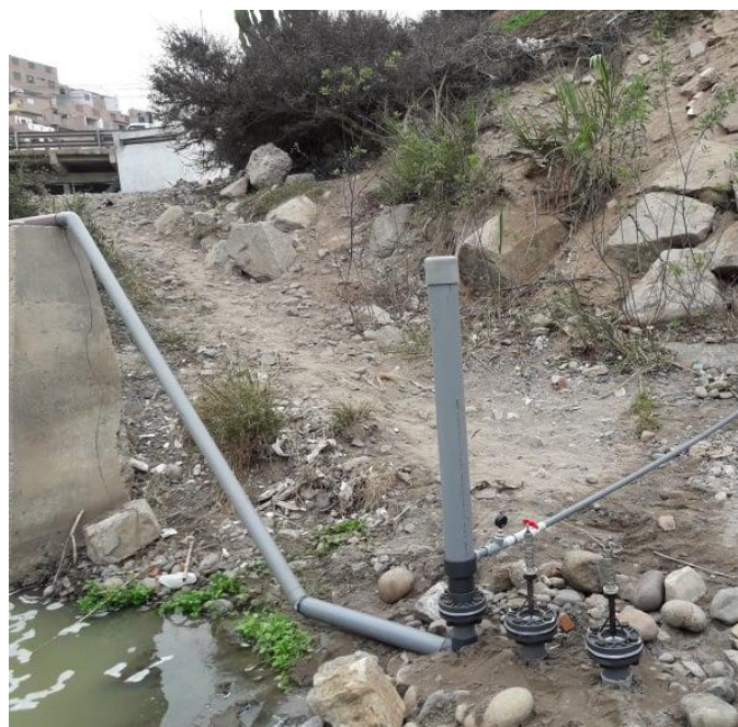
Imagen 5. Llegada de la tubería de alimentación a la bomba de ariete, bajado con un Angulo de 45 grados.
