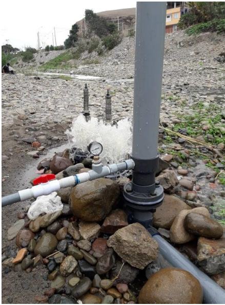
Imagen 3. Momento exacto del golpe de ariete provocando los 30 PCI de presión hacia la tubería de descarga.
