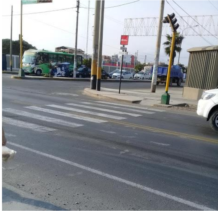
Figura 27: Paso de cebra en la Vía Evitamiento en mal estado, debido al desgaste de la pintura,
