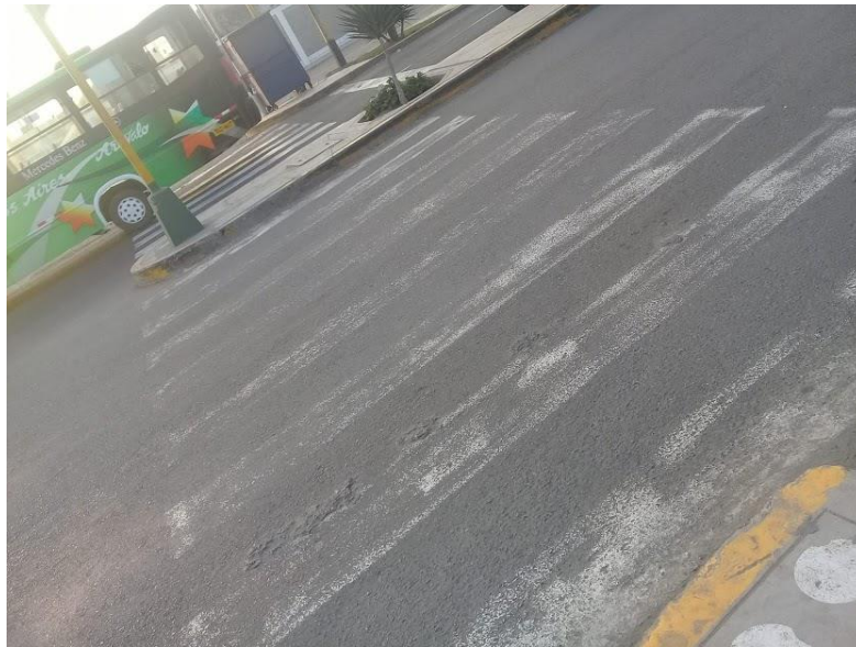
Figura 28: Paso de cebra en la Av. Larco, que apenas se puede visualizar, en pésimo estado, debido al desgaste de la pintura,
