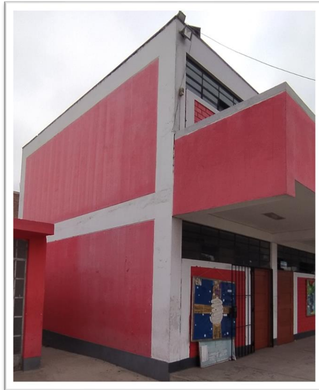
Figura 58. Detalle de vigas de amarre o corona del pabellón 11 – bloque A y B.
