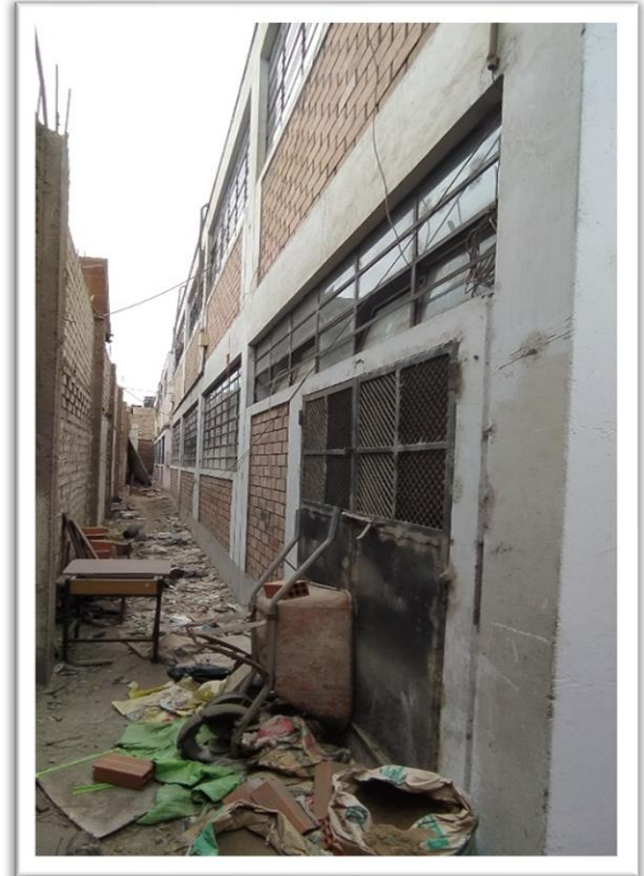
Figura 49. Estado de conservación de muros del pabellón 11 – bloques A y B.
