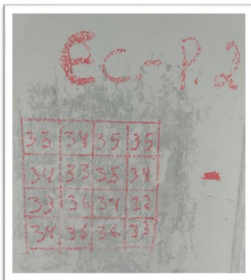
Figura 68. Lectura de disparos en la columna “P-2” del pabellón 11 – bloque B.
