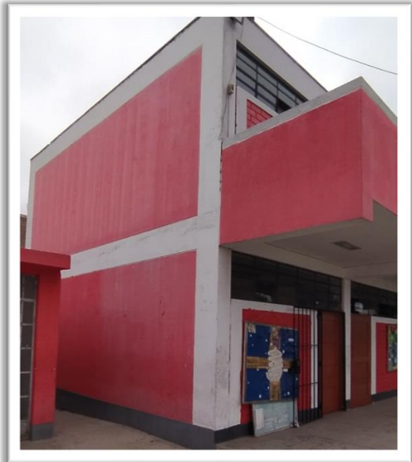
Figura 50. Estado de conservación de muros del Pabellón 11 – Bloques B.
