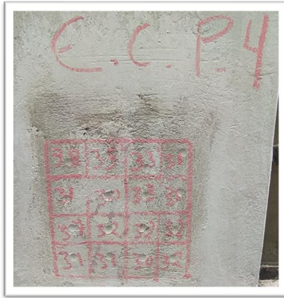
Figura 70. Lectura de disparos en la columna “P-4” del pabellón 11 – bloque A.
