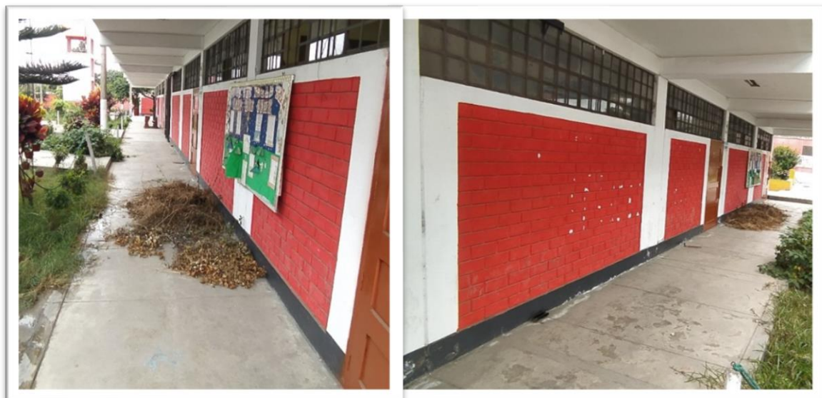
Figura 48. Estado de conservación de muros del pabellón 11 – bloques A y B.
