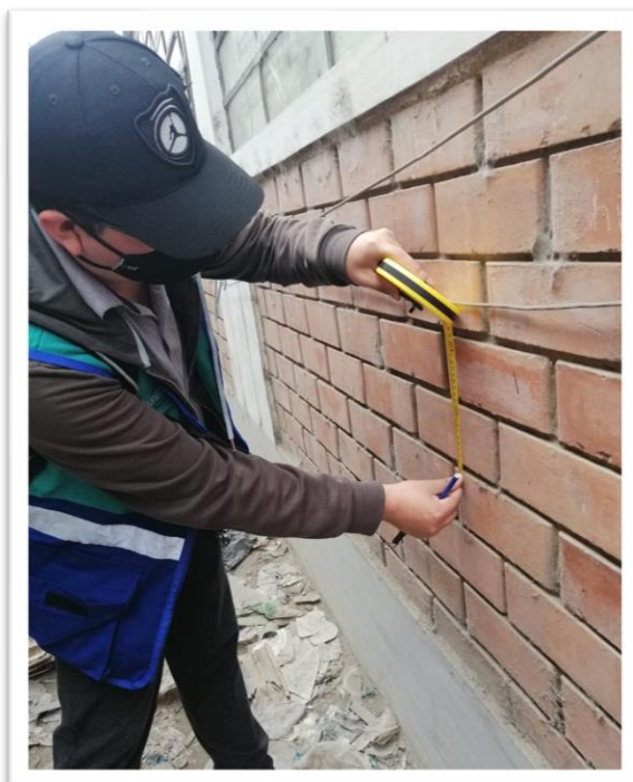
Figura 53. Juntas de pega de mortero de los muros de albañilería del pabellón 11 – bloque A.
