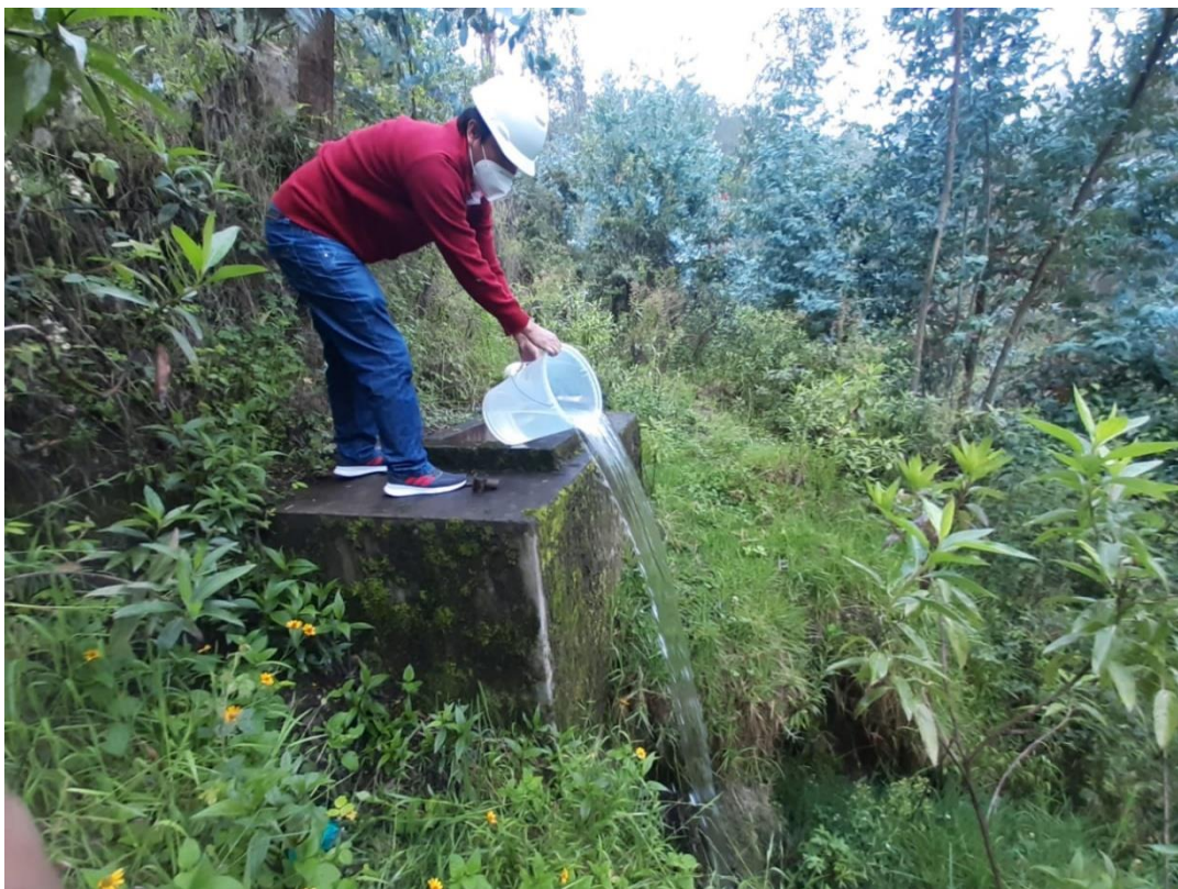
Aforo en Cámara Reductora de Presión 03.
