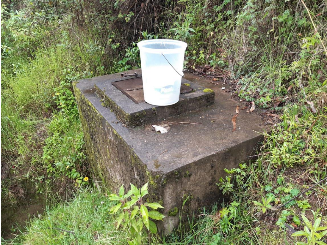
Aforo en Cámara Reductora de Presión 05.
