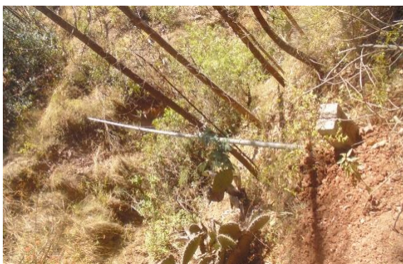
Figura1.1: Línea de conducción pase aéreo
