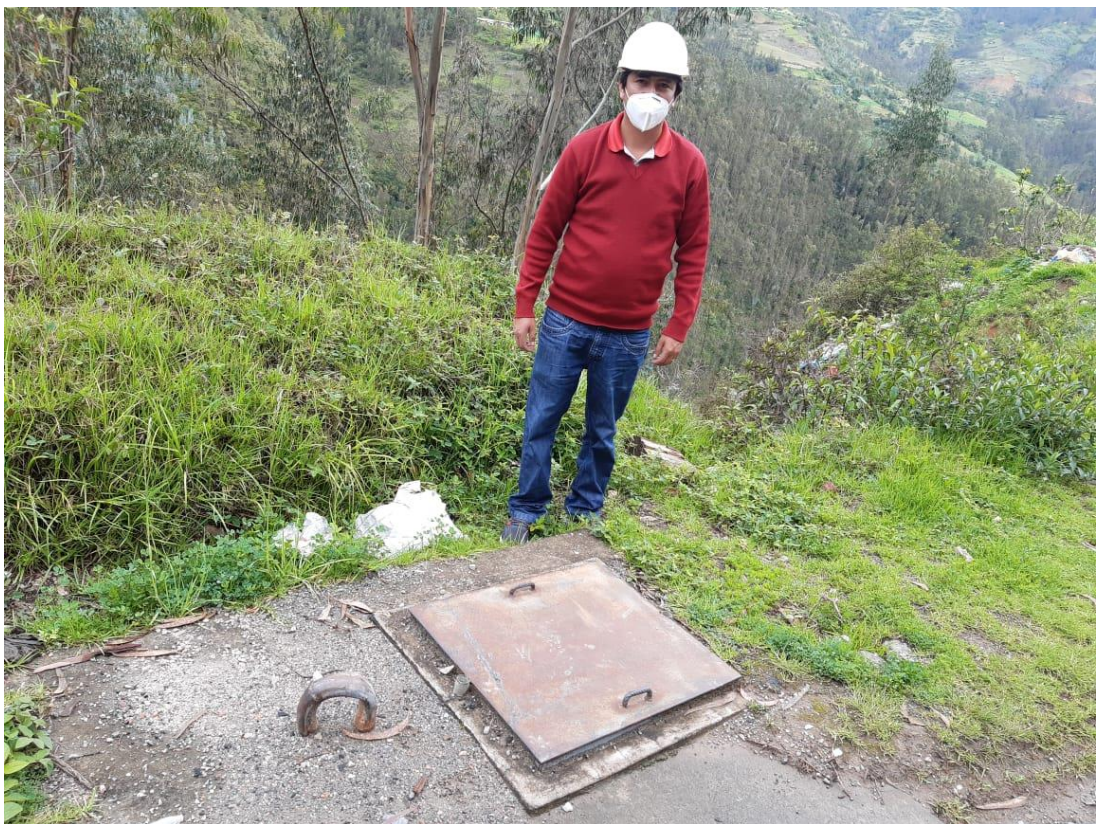
Aforo en Cámara Reductora de Presión 07.
