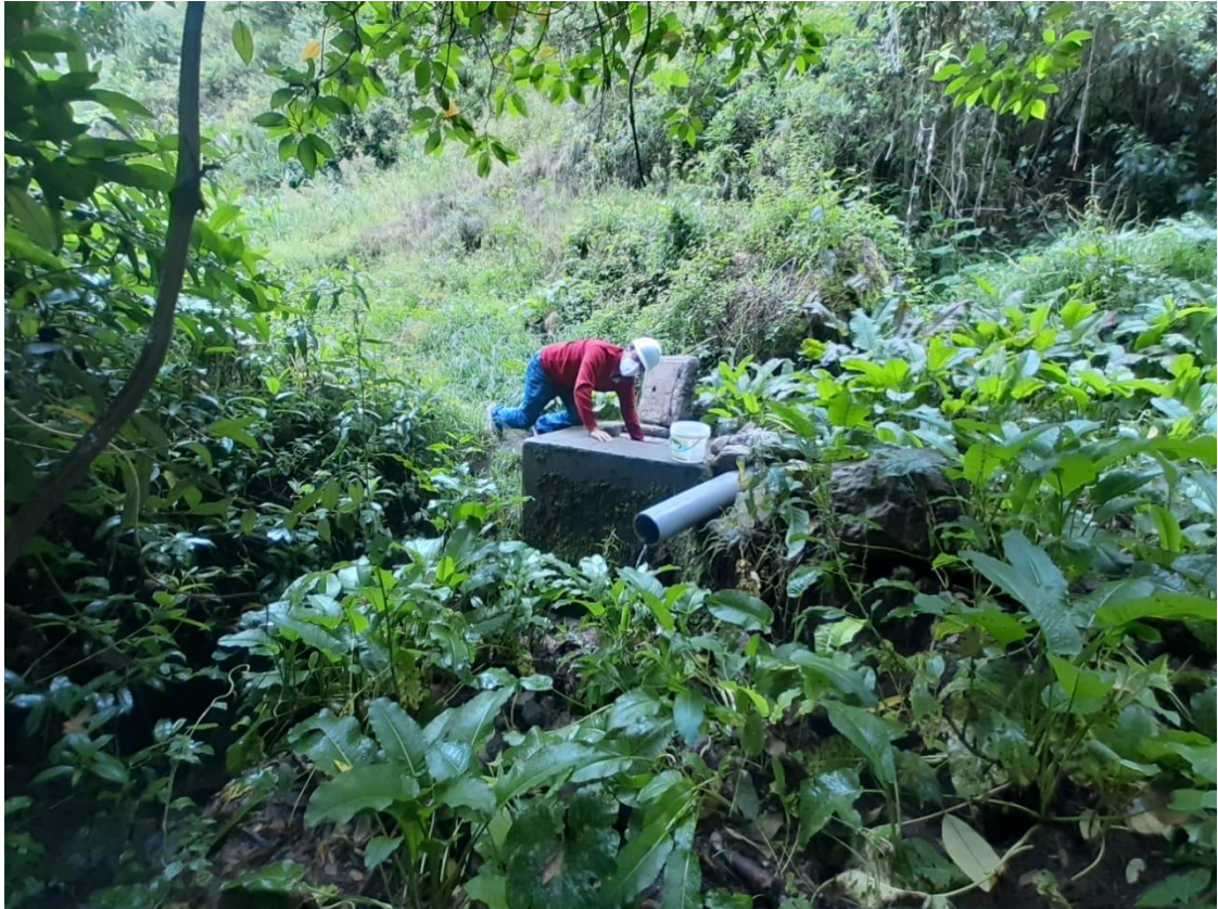
Aforo en Cámara Reductora de Presión 01.
