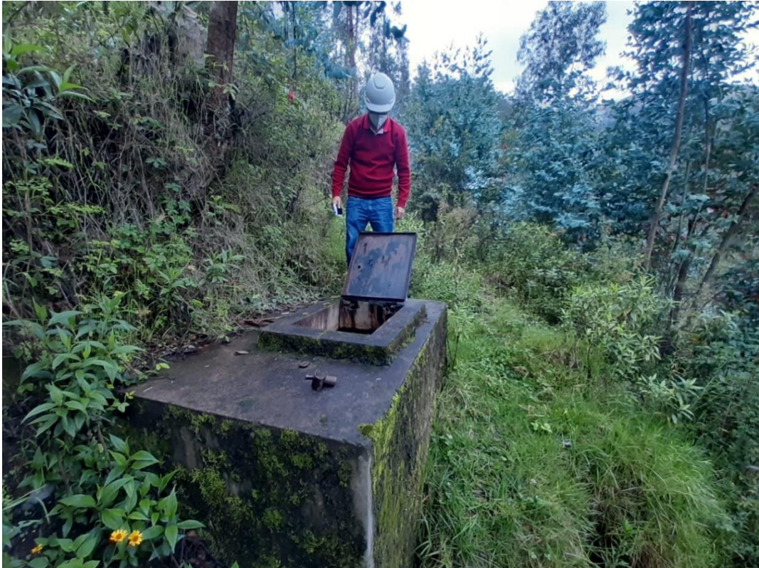
Aforo en Cámara Reductora de Presión 03.
