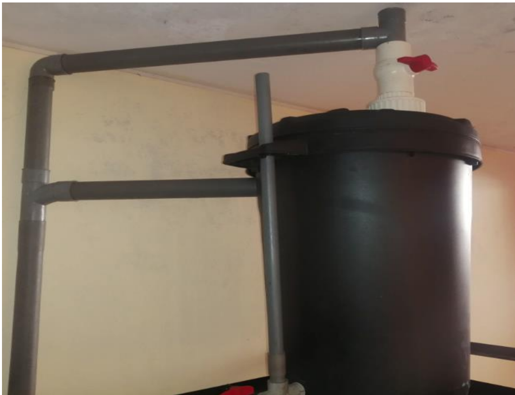
Foto N° 2: Filtro de agua gris
