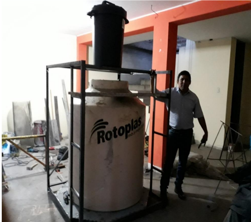
Foto N° 7: Sistema de reciclaje de agua gris
