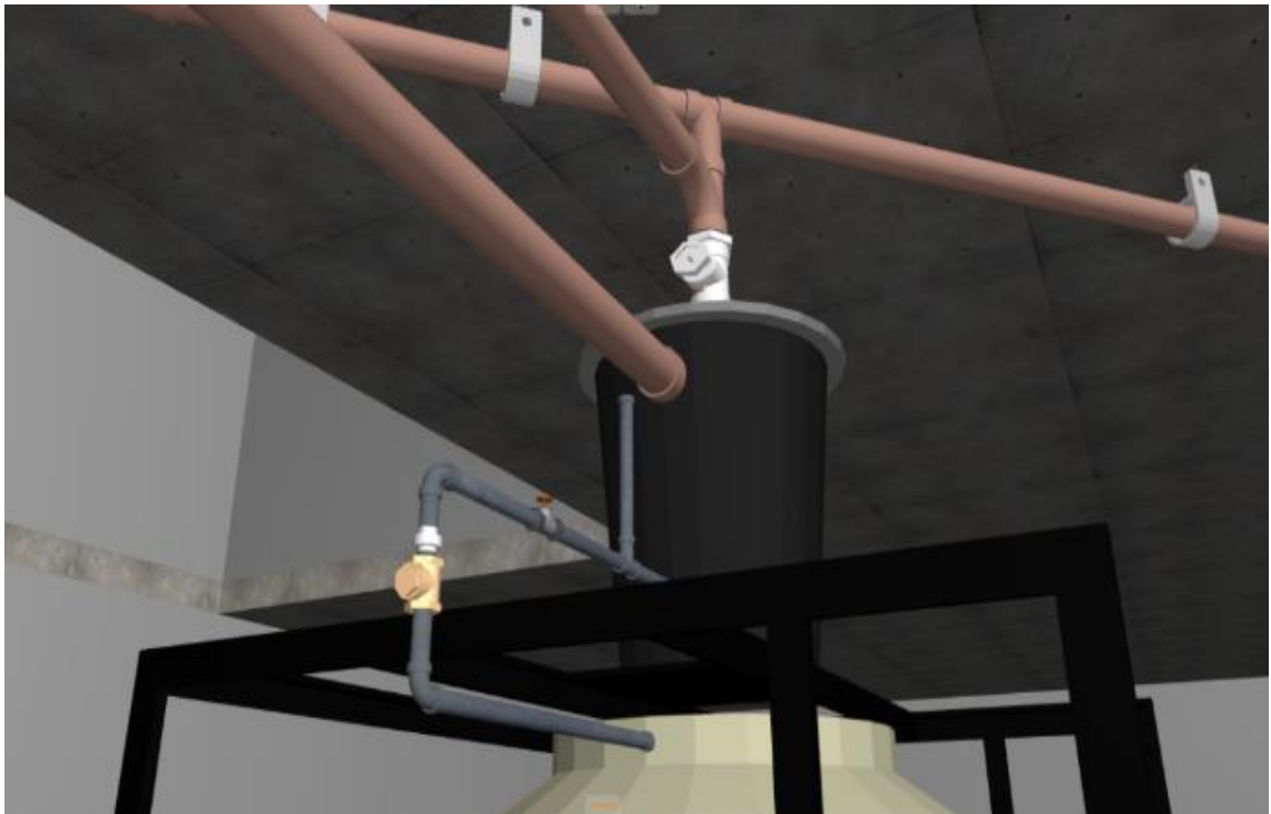
Figura N° 9: Conexión de tuberías a filtro y tanque de almacenamiento
