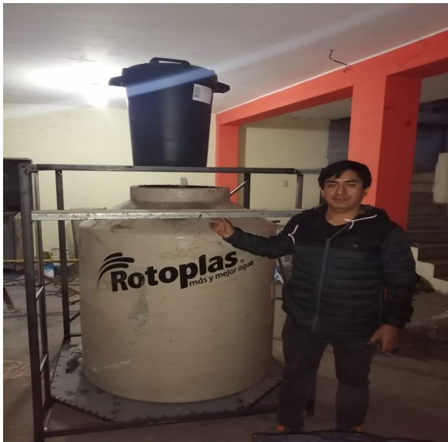
Foto N° 8: Sistema de reciclaje de agua gris
