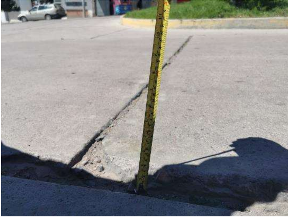
FOTOGRAFIA 05: Escala, Pulimiento del pavimento y Sello de junta cuadra 02 Av. San Felipe (norte – sur)
