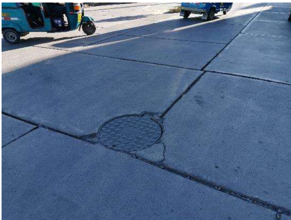
FOTOGRAFIA 02: Grieta de esquina y Sello de junta asfáltica cuadra 08 Av. Los Incas (Oeste - Este)
