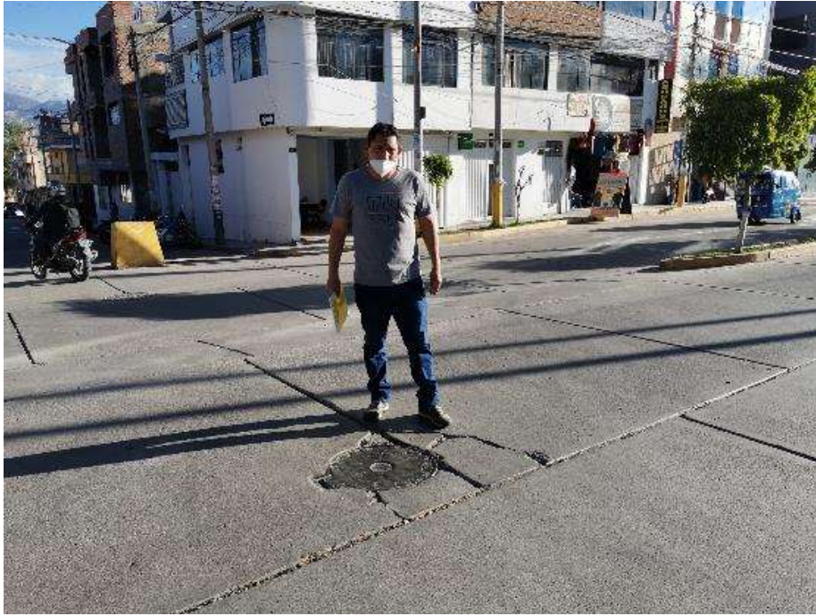
FOTOGRAFIA 03: Grieta de esquina y Sello de junta asfáltica cuadra 05 Av. los incas (Oeste Este)
