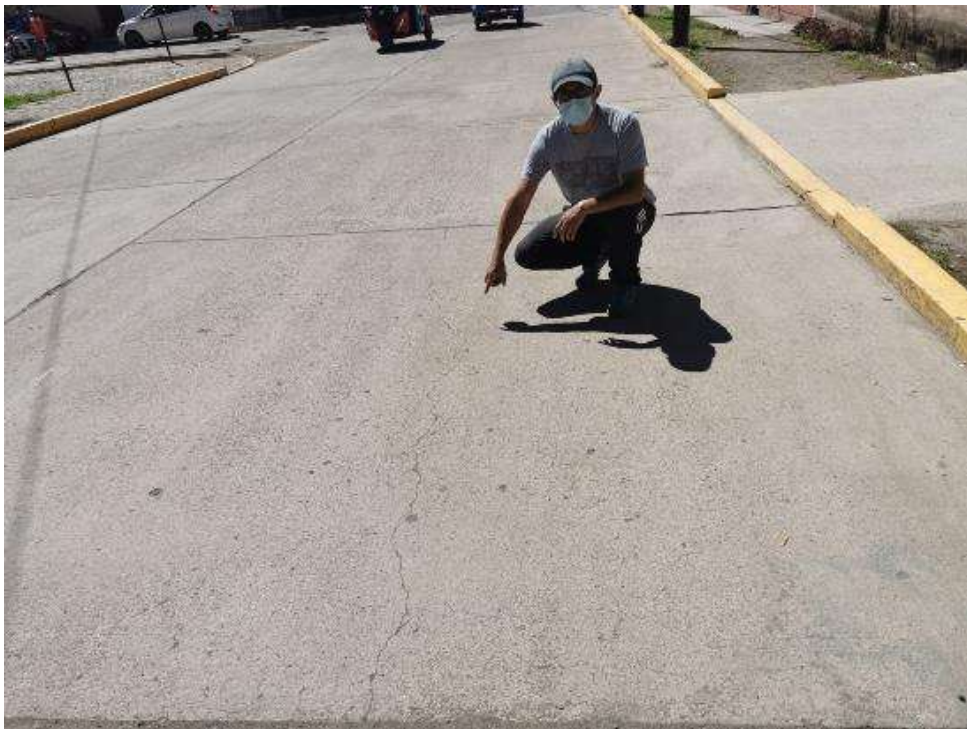
FOTOGRAFIA 10: Grieta lineal, Pulimiento y Sello de junta cuadra 03 Jr. Gervasio Álvarez
