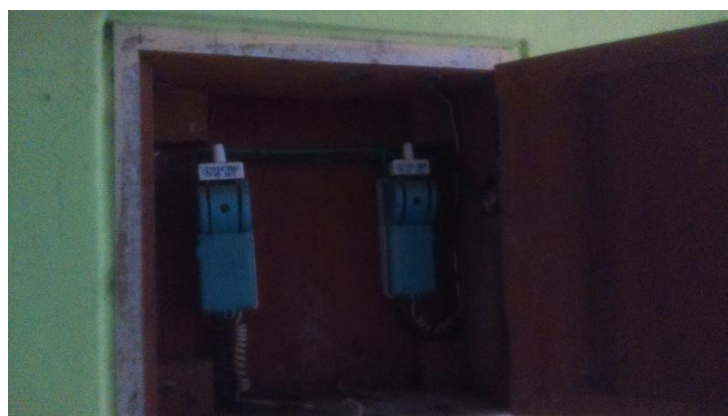
Sub Tablero N°1
