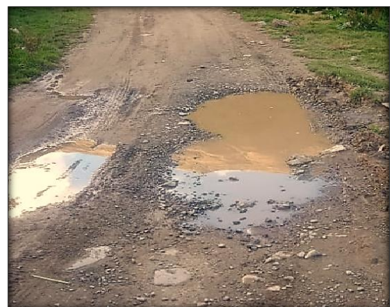
Figura 1: Fallas en la carretera de Andas Fuente: Elaboracion propia
