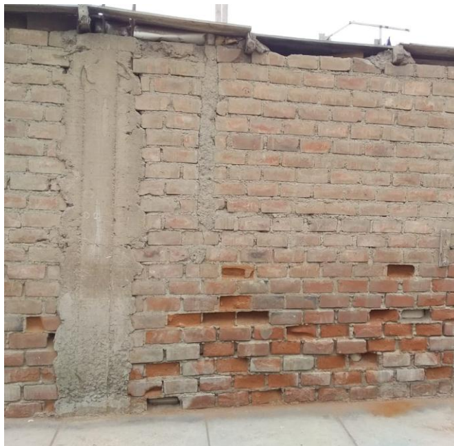
Figura 10. Humedad en todo el muro de albañilería.
