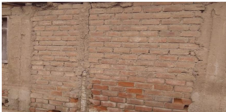
Figura 9. Grieta en el centro del muro de albañilería.
