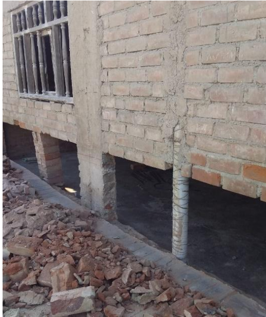
Figura 41. Corte del muro afectada por la humedad
