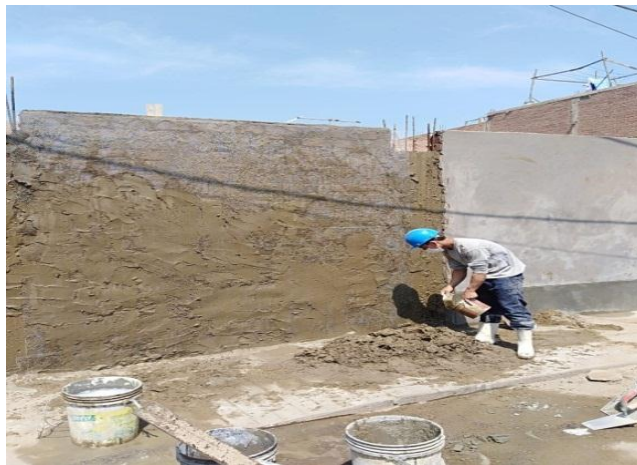
Figura 72. Lechada en el muro de albañilería
