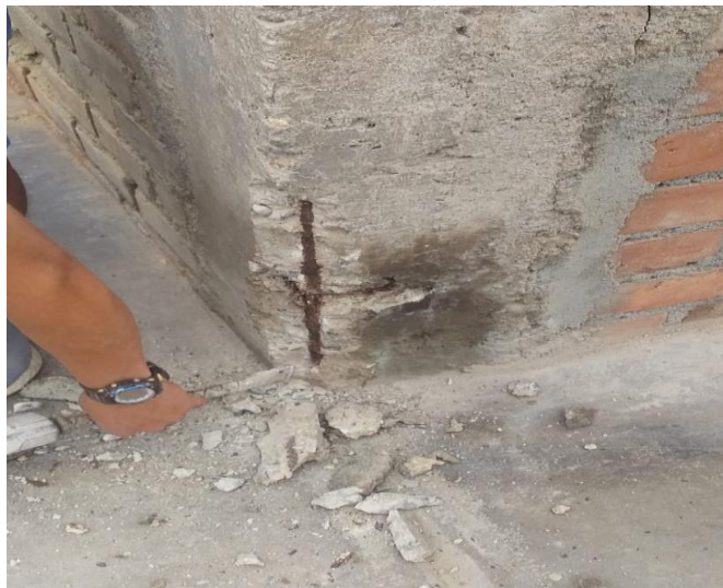
Figura 51. El acero de la columna en estado de oxidación
