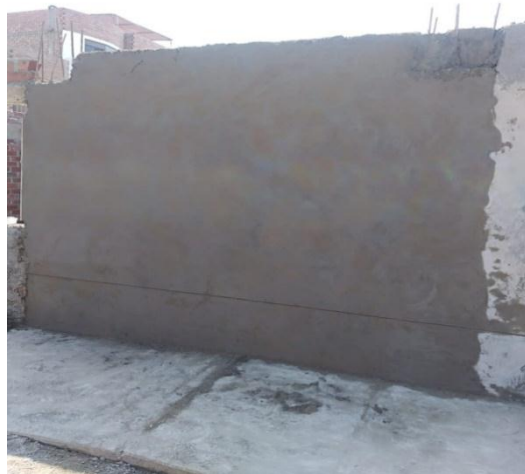
Figura 75. Vivienda reforzada de manera correcta
