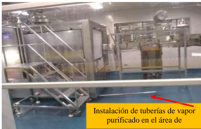
Fig. 20. Tubería de vapor. Fuente de la empresa ATE-2019
