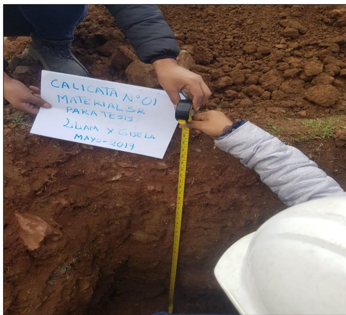
Figura 31: Excavación de calicata en acceso del distrito de santa Ana de tusi, Pasco.
