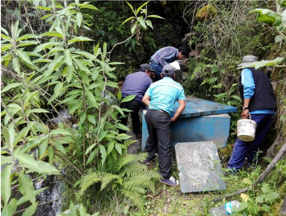
Figura 07 Toma de datos de la captación en la localidad de Rapi
