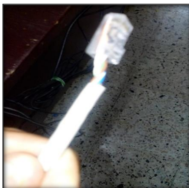
Ilustración 12 Cable mal ponchado
