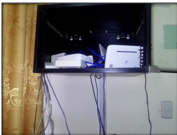
Ilustración 8 Router de la unidad de estadística e informática del hospital Chulucanas
