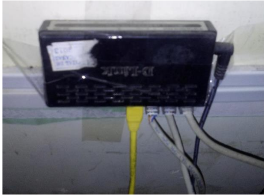
Ilustración 10 Switch convencional del hospital Chulucanas
