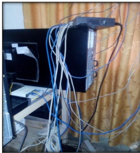
Ilustración 11 Cableado de red del hospital Chulucanas
