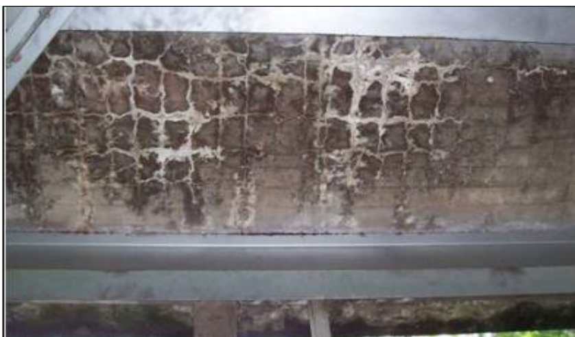
Figura 5. El proceso de la eflorescencia consiste en la aparición de manchas sobre el concreto
