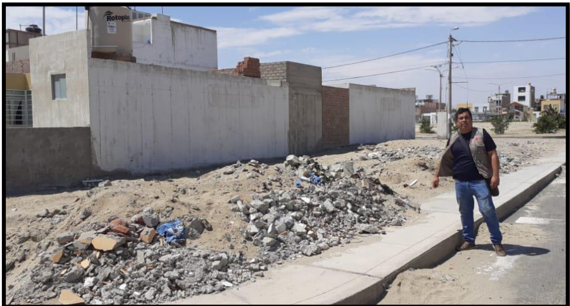
Y1: ACUMULACIÓN DE DESPERDICIOS DE CONSTRUCCIÓN, PRONCIPALMENTE CONCRETO Y LADRILLOS.
