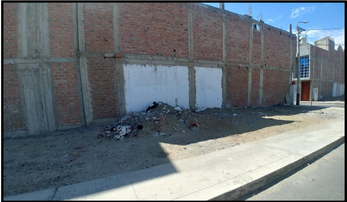
Y6: RESIDUOS DE CONSTRUCCION ABANDONADOS NUEVAENTE EN ESQUINAS DE LOTES
