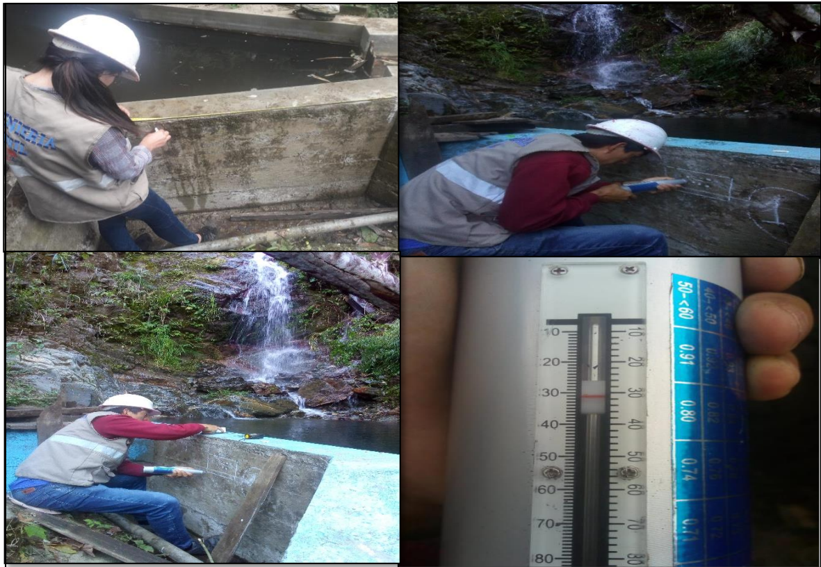
Figura 14: Ensayo de esclerometría
