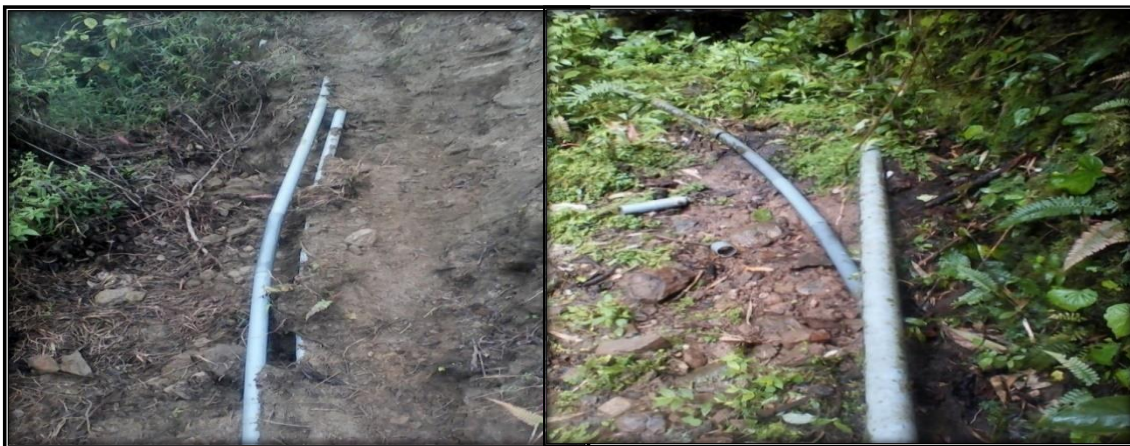
Figura 8: Tuberías expuestas conducción de agua.
