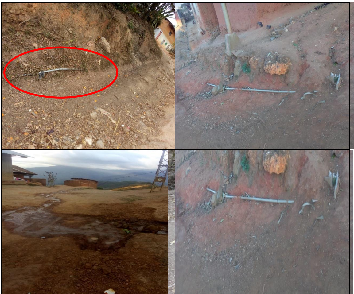
Figura 29: Evaluación visual de la red de distribución (rotura de tuberías en diferentes puntos).
