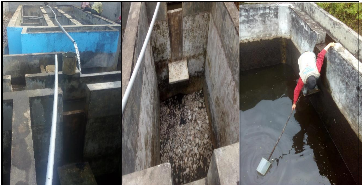
Figura 34: Filtros de agua en abandono
