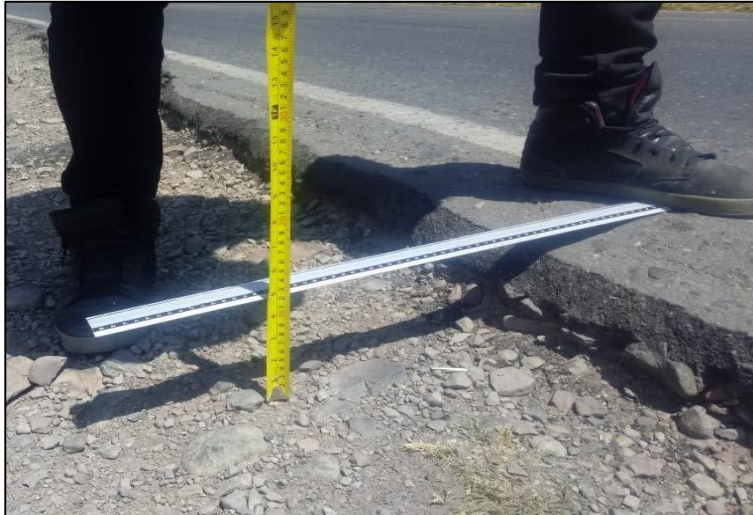
FIGURA 38: Desnivel Berma/ Carril – Progresiva km 1385+000 Fuente: Elaboración Propia
