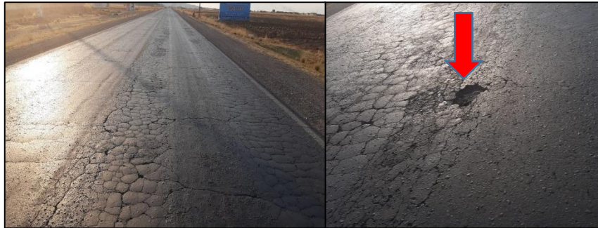
FIGURA 32: Falla Piel de cocodrilo – Progresiva km 1385+000 Fuente: Elaboración Propia
