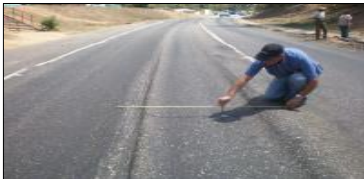
FIGURA 21: Abultamiento y Hundimientos, Alto Fuente: Maestría en vías terrestres, módulo III
