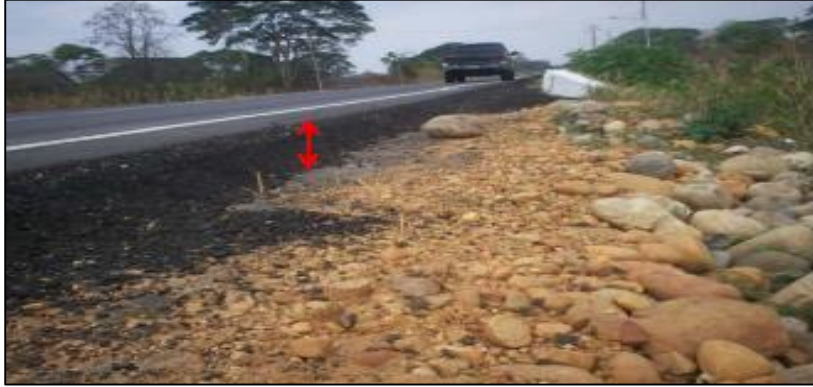
FIGURA 15: Desnivel Carril/Berma Fuente: Maestría en vías terrestres, módulo III
