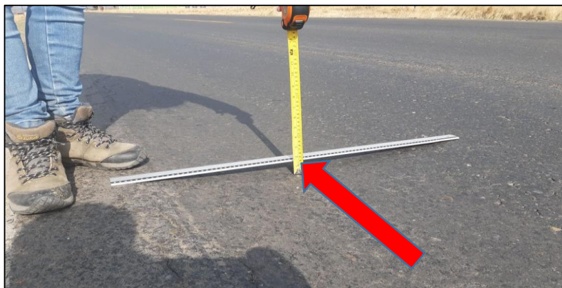
FIGURA 36: Depresión– Progresiva km 1385+000 Fuente: Elaboración Propia
