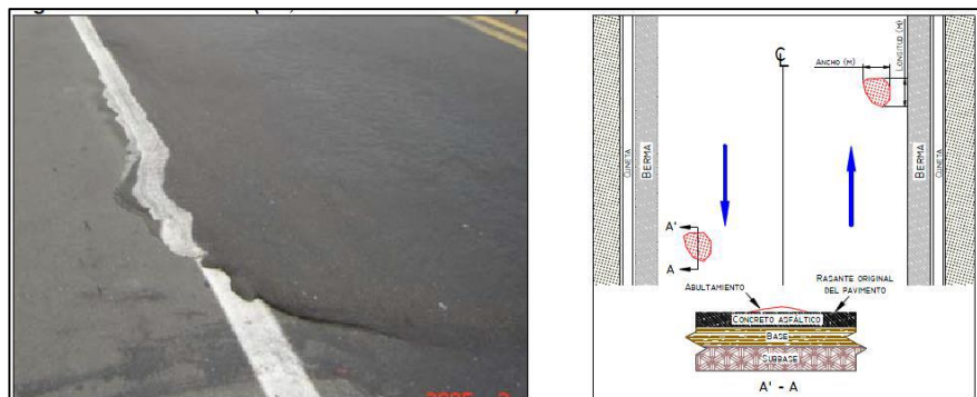
FIGURA 09: Abultamiento y Hundimientos, Bajo, Medio Fuente: Manual para la inspección visual de pavimentos flexibles (2006)
