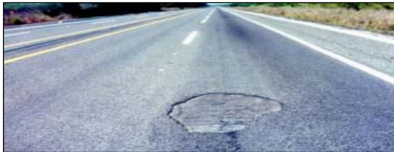
FIGURA 19: Abultamiento y Hundimientos, Alto Fuente: Maestría en vías terrestres, módulo III
