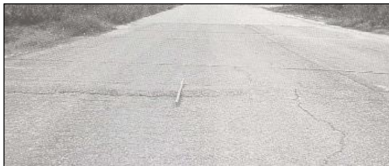
FIGURA 24: Abultamiento y Hundimientos, Alto Fuente: Maestría en vías terrestres, módulo III
