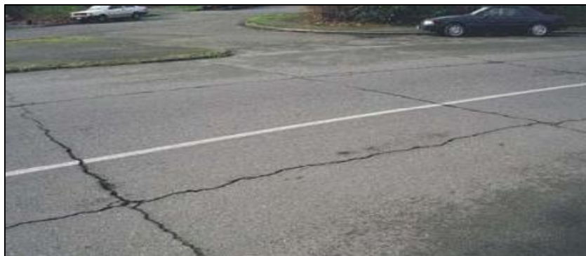
FIGURA 14: Grieta de Reflexión de Junta Fuente: Maestría en vías terrestres, módulo III
