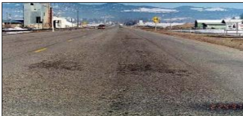
FIGURA 25: Abultamiento y Hundimientos, Alto Fuente: Maestría en vías terrestres, módulo III
