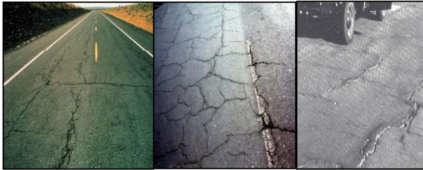
FIGURA 08: Agrietamiento en Bloque, Nivel de severidad Bajo, Medio, Alto. Fuente: Maestría en vías terrestres, módulo III
