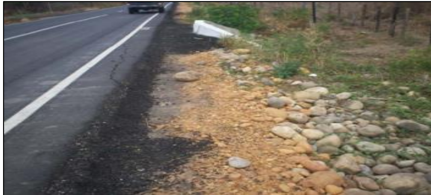
FIGURA 13: Grieta de Borde Fuente: Maestría en vías terrestres, módulo III
