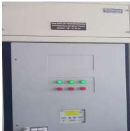
Figura 19. Estado actual de pulsadores.
