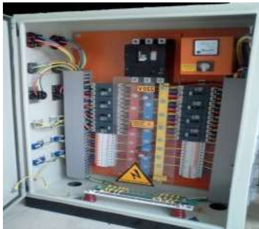
Figura 4. Tablero eléctrico de distribución.
