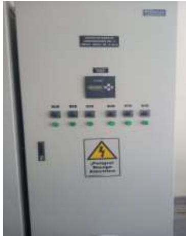
Figura 16. Estado actual de tablero de fuerza.
