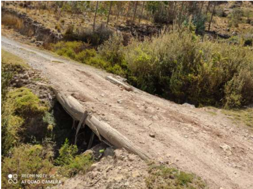
Faltas de obras de arte
