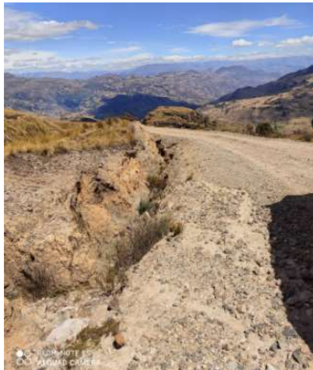
Socavación de cunetas
