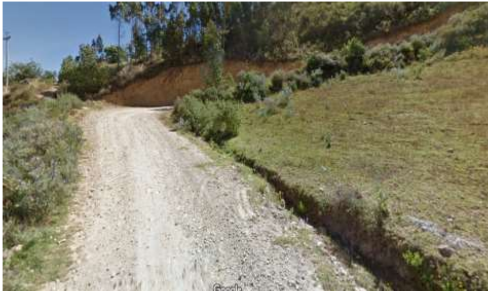
Figura N°27: Obras de arte deficientes
