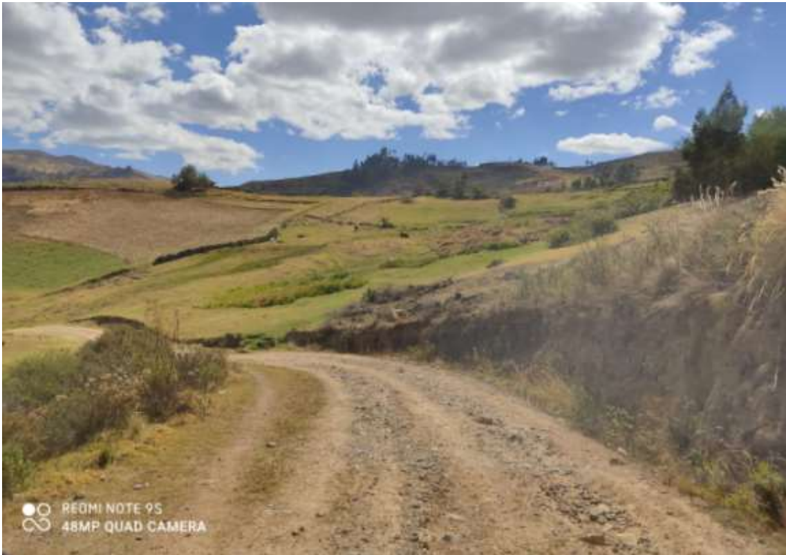
Ahuellamiento de la carretera
