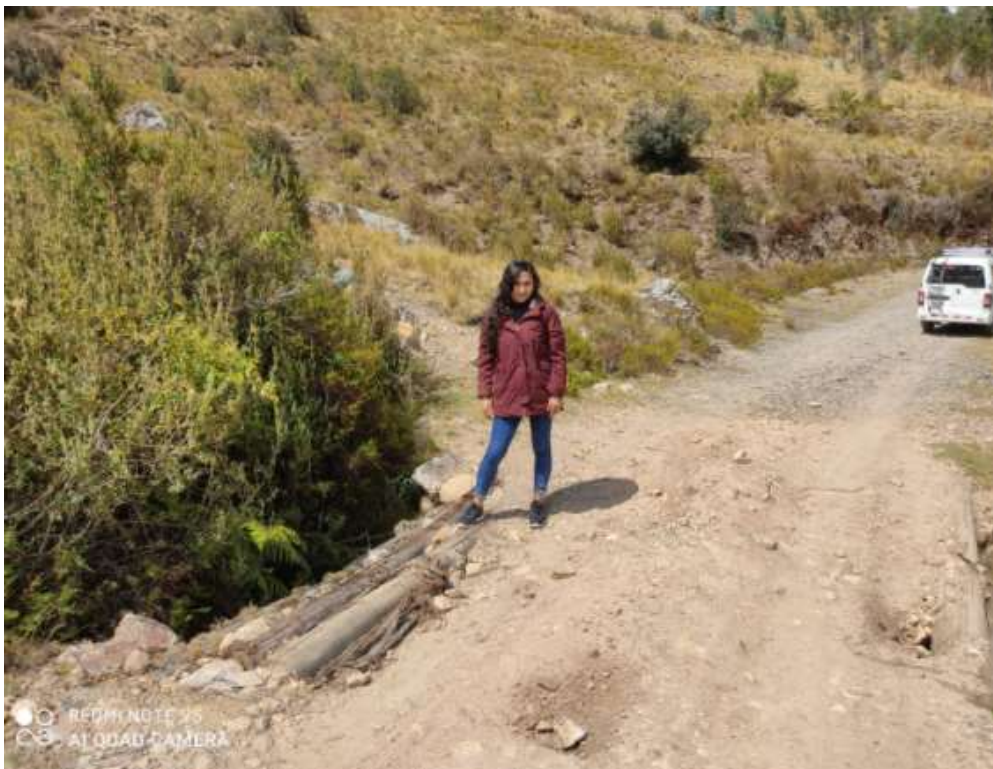
Trocha carrozable en mal estado, además no cumple con el ancho de vía mínimo.
