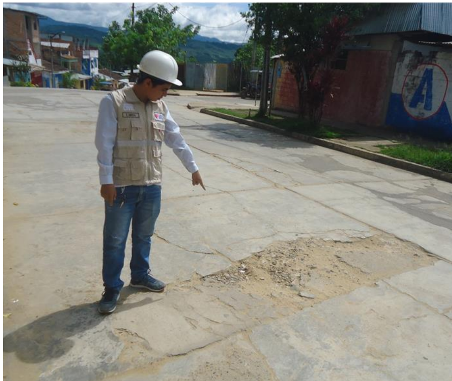
Asentamientos o levantamiento de losas del pavimento rígido.
