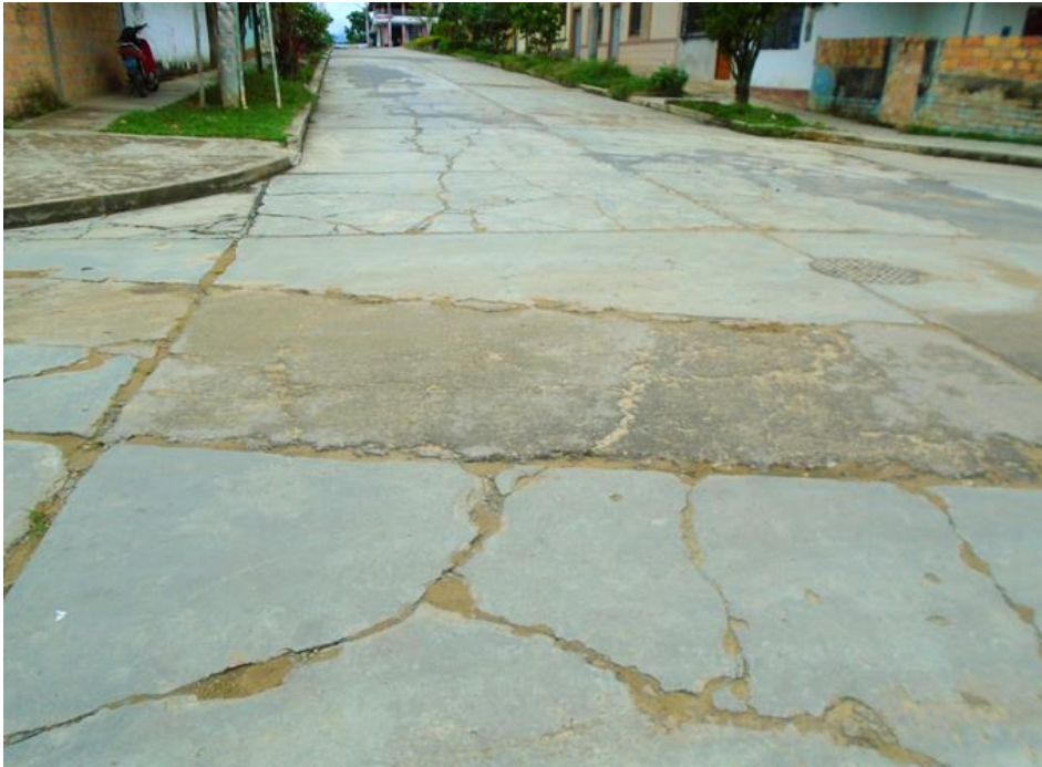
Grietas y fisuras longitudinales y transversales en el pavimento rígido.
