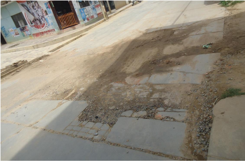
Asentamiento de losas por el incremento de carga.
