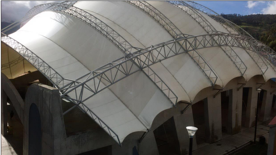
Figura II. Polideportivo del Colegio Gregorio Martinelly, de la ciudad de Andahuaylas. Fuente: Elaboración propia.
